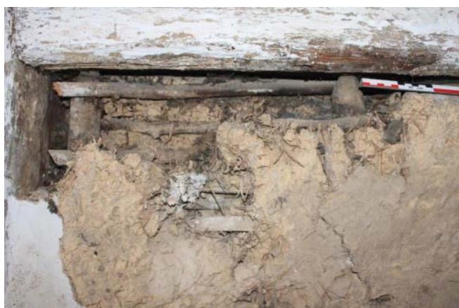
Figure 15 – Détail du torchis toujours en place dans le pignon primitif.
