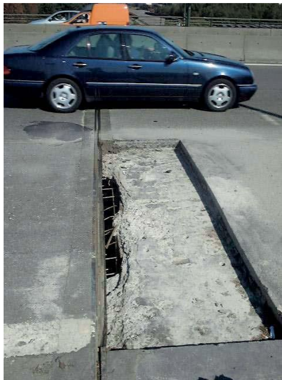
Figure 1: Illustration de la dégradation d'un pont de Bastogne (Demars Ph., 2001)
