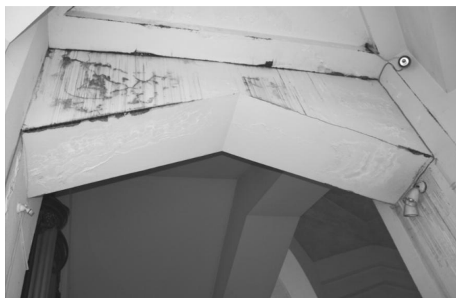
Fig. 18. Traces de rouille et d'humidité sur une poutre reliant un pilier de l'absidiole sud-ouest à un pilier entourant la rotonde, église Saint-Vincent.
