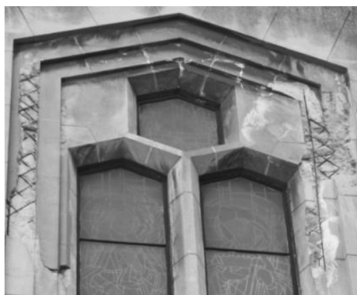
Fig. 17. Épaufrures autour de la baie nord-ouest du chœur de l'église Saint-Vincent.
