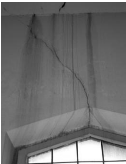
Fig. 15. Fissure en partie haute de la grande baie éclairant la galerie, en façade est de l'église Saint-Vincent.
