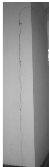
Fig. 16. Fissure verticale en face latérale d'un pilier de l'absidiole sud-est, église Saint-Vincent
