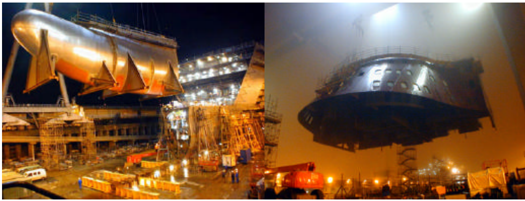
Montage du bulbe et de la façade avant du QM2 (Source photo: ALSTOM)
