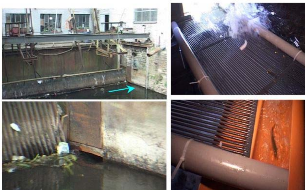
Figure 9. Vues (à gauche) de l'exutoire de dévalaison latéral (débit : 0,1-0,2 m 3 /s ; vitesse : 1-1,2 m 3 /s) aménagé dans le prolongement latéral de la grille de la prise d'eau de la centrale hydroélectrique Mérytherm (10 m 3 /s maximum) sur l'Ourthe et (à droite) du système de récupération des poissons (extrait du film de présentation de ProFish Technology).
