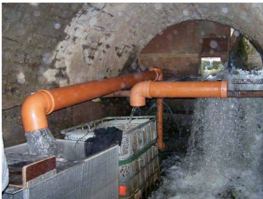
Figure 10. L'installation de récupération dans des viviers des poissons qui passent par l'exutoire de surface (grille à droite) et par l'exutoire de fond (siphon à gauche).
