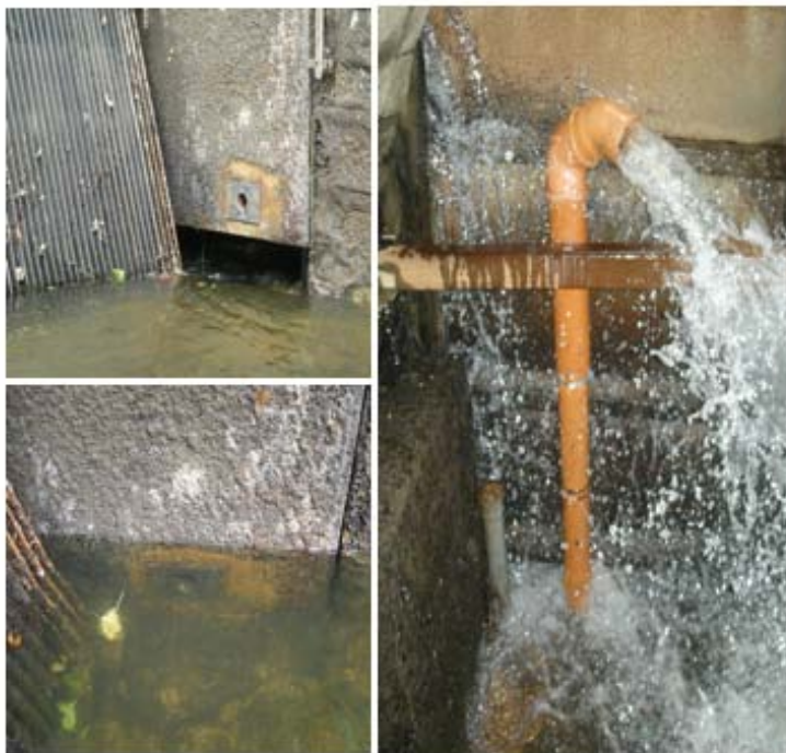
Figure 8. Aménagement d'un exutoire de fond latéral en amont de la grille de protection de la prise d'eau de la centrale hydroélectrique de Méry sur l'Ourthe : (gauche haut) vanne latérale soulevée ; (gauche bas) orifice de dévalaison de fond percé dans la vanne latérale ; (droite) tuyau en siphon permettant la capture des poissons qui utilisent l'exutoire de fond (documents ProFish Technology).
