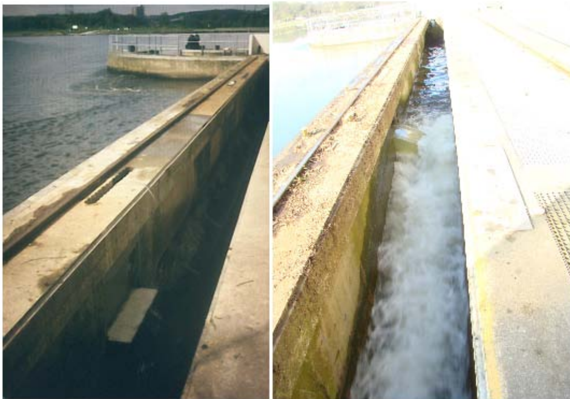
Figure 28. Vue en position fermée de l'exutoire expérimental de dévalaison des smolts de salmonidés aménagé au-dessus du plan des grilles de prise d'eau de la centrale hydroélectrique SPE de Lixhe. Les caractéristiques techniques du dispositif sont :
