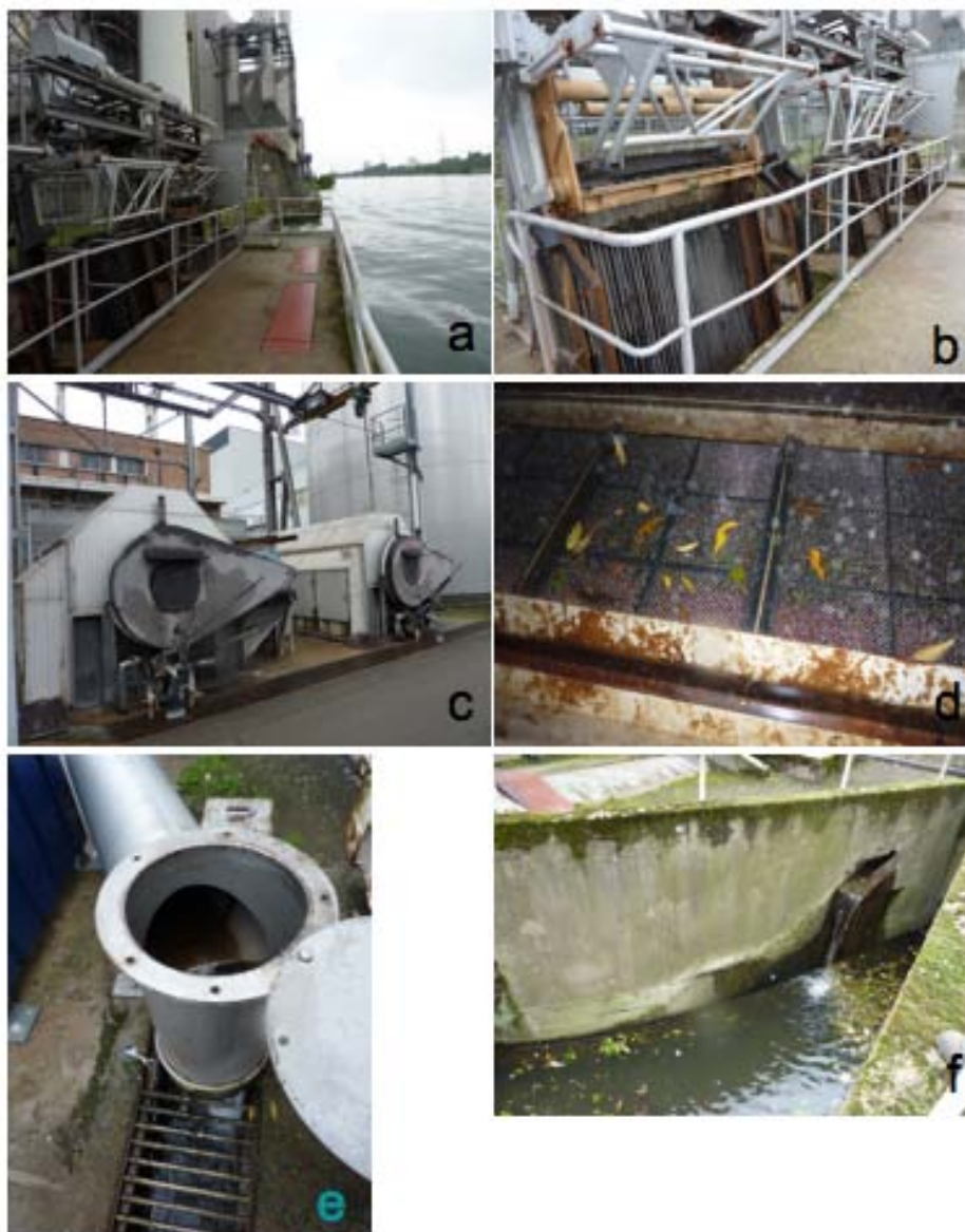
Figure 15. Photos des prises d'eau de refroidissement de la centrale électrique thermique des Awirs sur la Meuse. (a) Alignement des prises d'eau T5 (avant-plan) et T4 en berge gauche de la Meuse ; (b) Prise d'eau T5 avec ses 3 grilles à barreaux espacés de 5 cm (c) Filtres à chaîne de T5 (d) Treillis à mailles de 4 mm du filtre à chaîne de T4 en fonctionnement ; (e) Produits de lavage du filtre à chaîne de T4 évacués dans un caniveau puis restitués en aval dans le Ruisseau des Awirs (f) Restitution au Ruisseau des Awirs des produits de lavage des filtres à chaîne.
