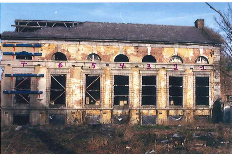
◀ La maison des Ingénieurs, façade extérieure vers le "château". Dernier état des enduits ocre jaune, au moment de l'analyse en 1998, qui ont fait jusqu'ici l'image du Grand-Hornu. Etat catastrophique du bâtiment laissé à l'abandon depuis 1955, avant restauration-reconstruction.
