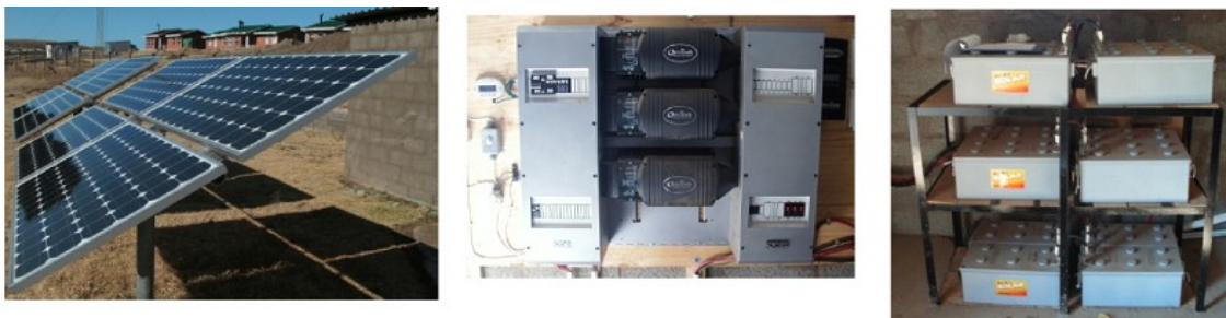
Figure 23: Système photovoltaïque de 3 kW e
