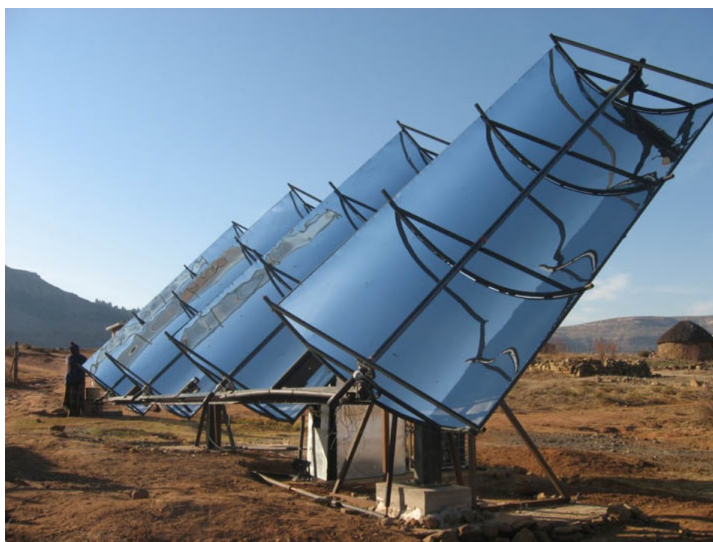
Figure 21: Second prototype d'ORC solaire, installa à Ha Teboho
