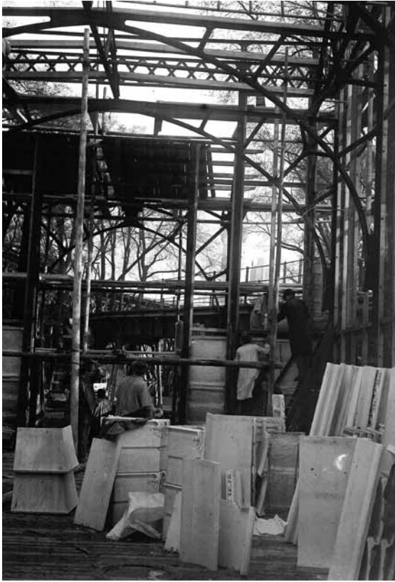
Ill. 4 : Vue intérieure du pavillon. Placement des panneaux de staff, Paris, 1900, © CRMSF.
