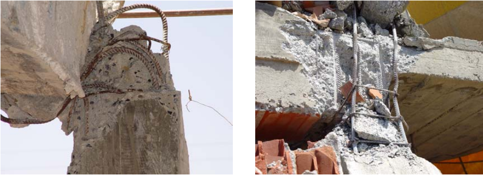
Figure 10.27. Ruine due à l'absence d'armature transversale au nœud.
