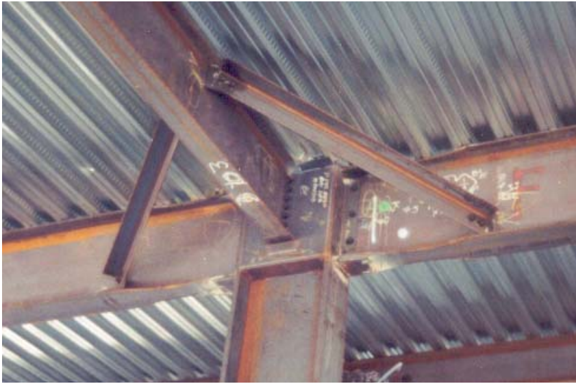
Figure 9.25. La stabilisation transversale des zones de rotules plastiques sous M^+ et M^- est nécessaire à leur efficacité.
