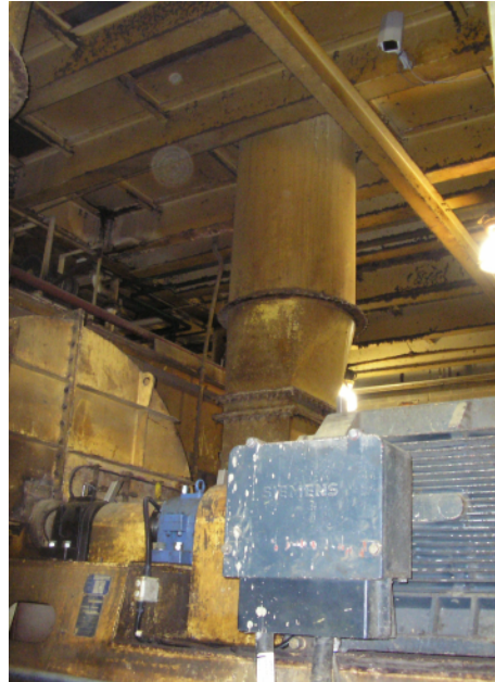
Figure 1. Vue de la machine observée par thermographie infrarouge. A l'avant plan à droite, le moteur; à gauche du moteur, les deux paliers (l'un bleu, l'autre noir); à l'extrême gauche, le carter du ventilateur; en haut à droite, le boîtier de protection contenant la caméra.
