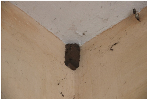
Vue d'un nid d'insectes destructeurs
