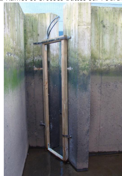
Station de détection de Monsin - Liège
