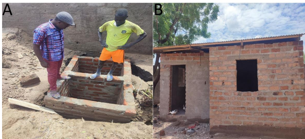
Figure 4.3 : Une fosse septique compartimentée et montée en brique cuite avec du mortier comme liant (A) puis une maison de trois pièces (B) construite en brique de terre cuite avec du mortier comme liant. Source : Idrissou Mounpe, Enquête de terrain, mai 2023, Pitoa.
