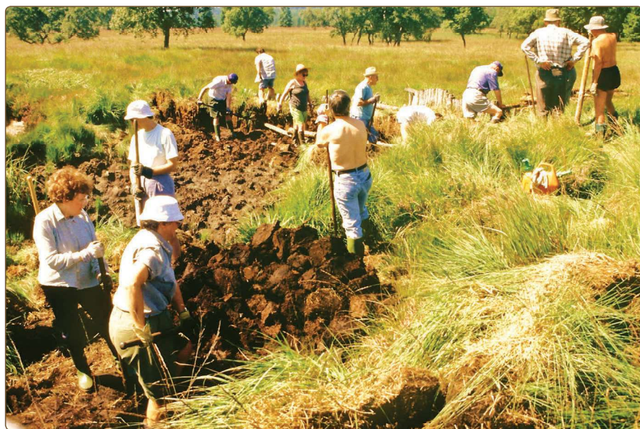
Photo 1. Cette photo datant du siècle dernier montre un chantier des « Amis de la Fagne » visant à barrer un drain à Cléfiay au moyen de palissades en bois d'épicéa et d'un colmatage de tourbe. Les efforts de ces bénévoles ont rapidement montré leurs limites et leur efficacité relative mais ils ont tracé la voie à suivre pour tenter de restaurer les tourbières. Il fallait cependant mettre au point de meilleures techniques, avec davantage de moyens, ce que les projets LIFE ont pu concrétiser de manière spectaculaire. (Doc. « Les Amis de la Fagne »).
