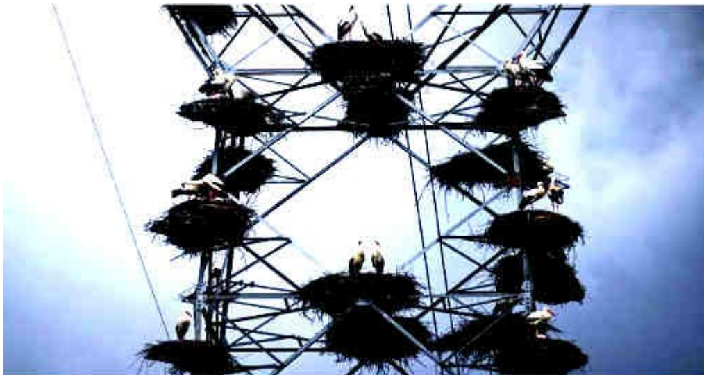
Des cigognes nichent sur un pylône électrique à Coimbra, le 16 février 2024 au Portugal PHOTO AFP / PATRICIA DE MELO MOREIRA
