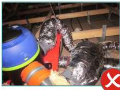
2 : Conduits souples présentant de trop nombreux coudes parfois supérieurs à 90°
