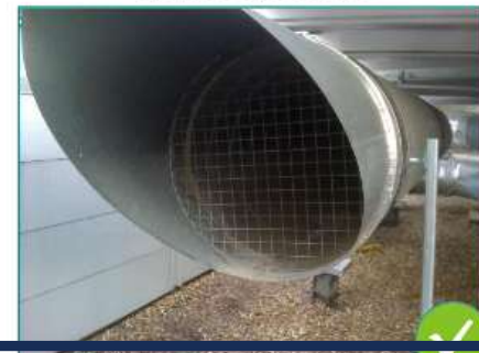
3 : Prise d'air protégée par une grille
