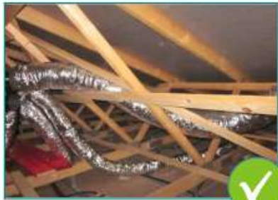
1 : Conduits souples correctement mis en œuvre (pas d'écrasement ni de coude supérieur à 90°)
