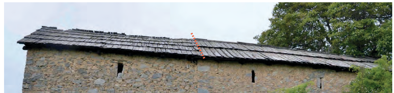
Toiture vue de l'est, et rupture dans les couvertures nord et sud. Cliché de V. Labbas, 2012
