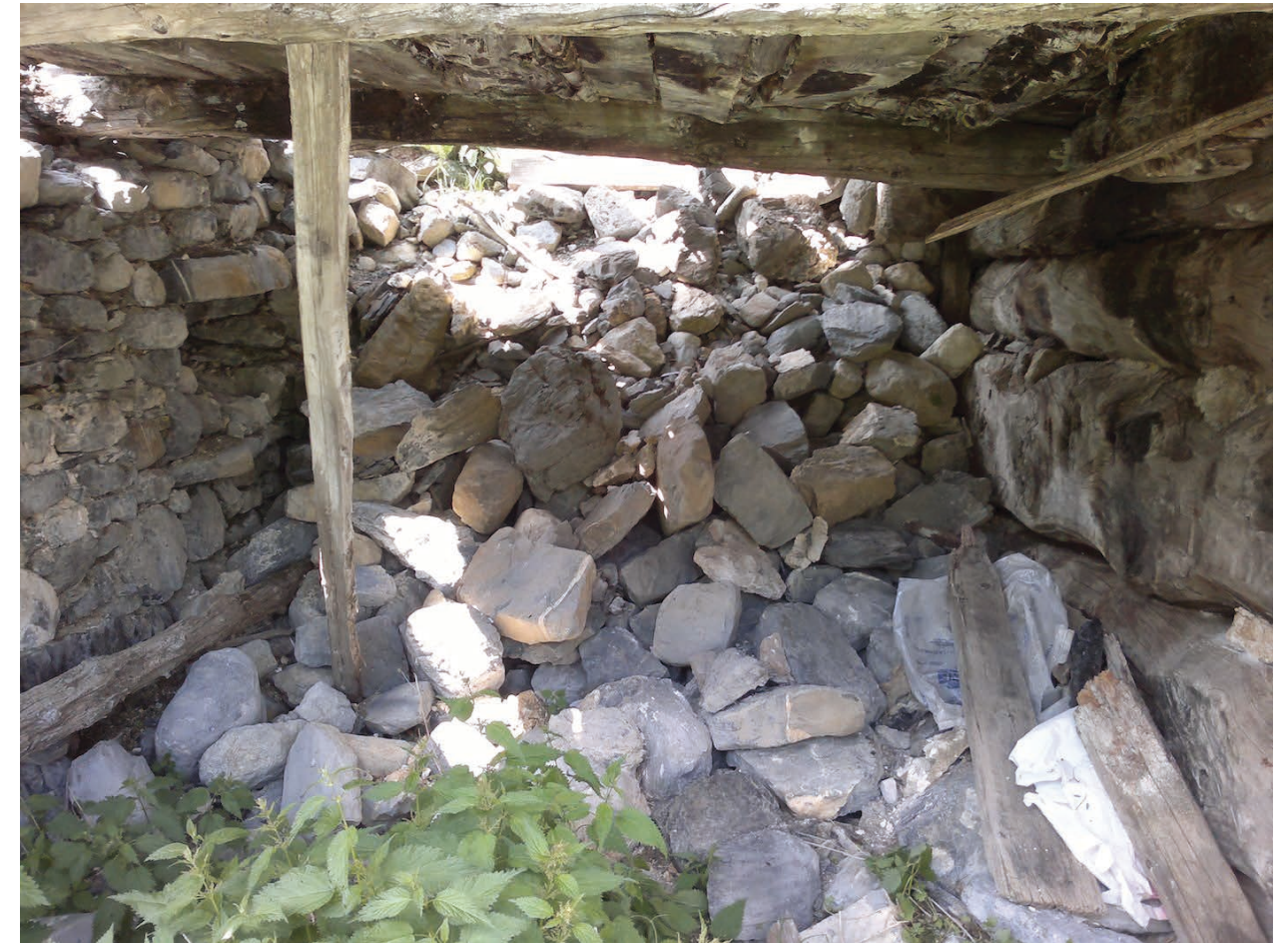
Vue du mur en pierre sèche effondré au nord.
