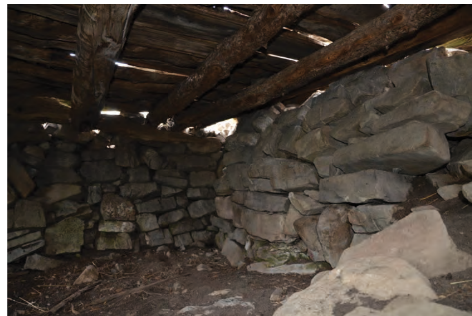
MR 503. l'effondrement de la partie est au premier plan et le mur 502 en arrière plan.
