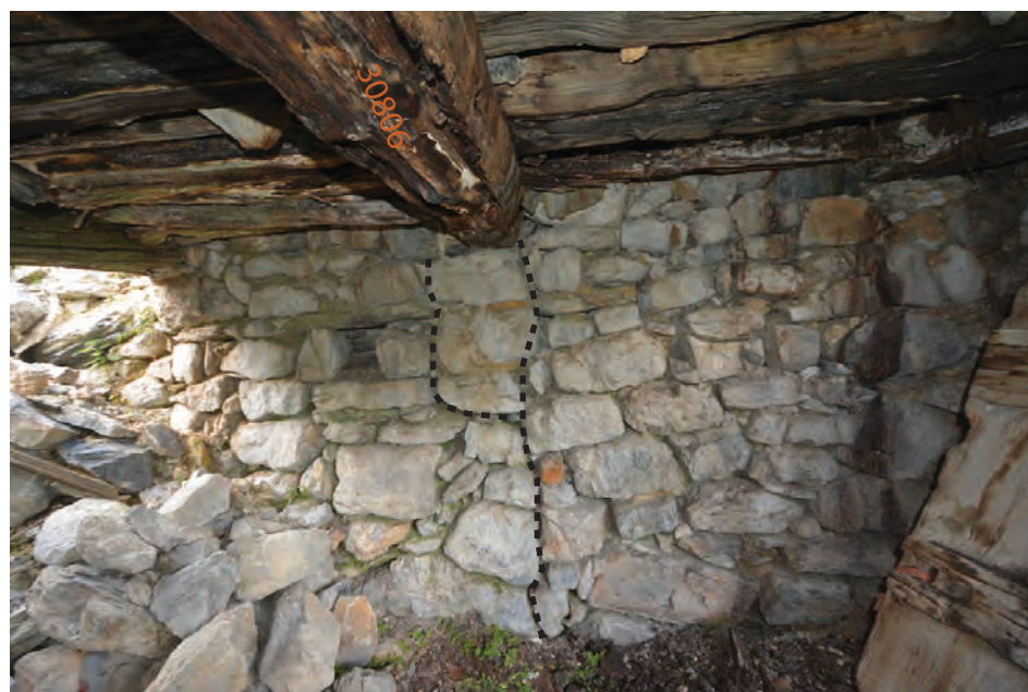
MR 302, parement interne au niveau de R0 à l'ouest. Rupture verticale dans la maçonnerie au niveau de la poutre 30806.
