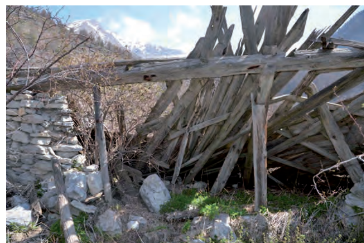
Arrachement du parement Cliché de V. Labbas, 2012
