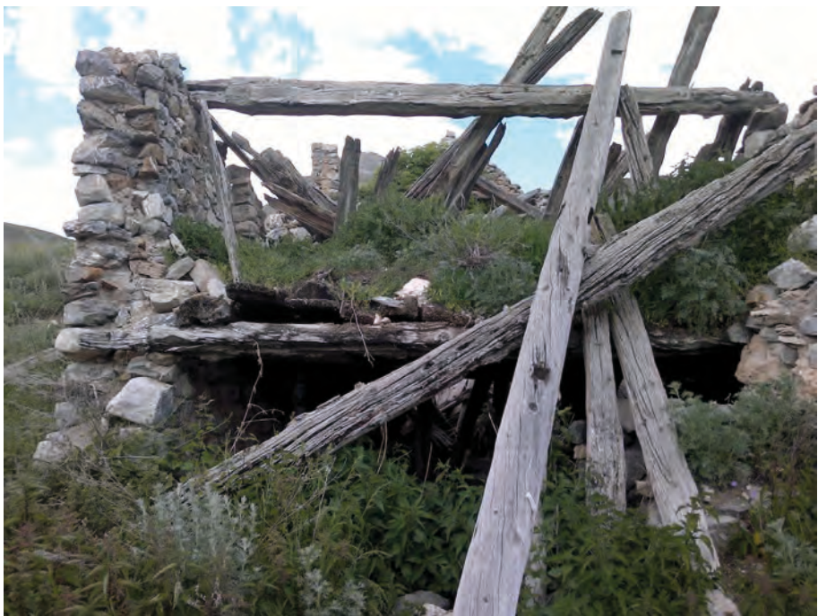
Le mur 303 effondré laissant apparaître le plancher 308.
