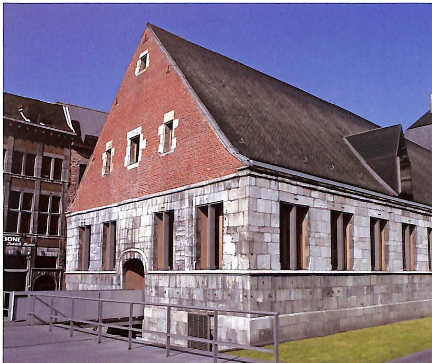
Fig. 4.- Ancienne halle aux viandes : fenêtres brutalisées. © Ville de Liège.
