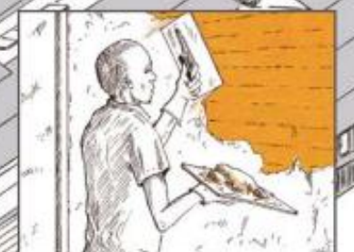
LES MURS SONT ENDUITS À L'ARGILE À L'INTÉRIEUR ET À LA CHAUX À L'EXTÉRIEUR. CHAQUE FINITION EST EN TROIS COUCHES. LA COUCHE D'ACCROCHE (GOBETIS) ENROBE TOTALEMENT LES BRINS DE PAILLE AVEC AU MINIMUM 10 MM DE PÉNÉTRATION. LE CORPS D'ENDUIT TRAMÉ, D'UNE ÉPAISSEUR DE 20 À 30 MM, VISE À RATTRAPER L'PLOMB. L'ENDUIT DE FINITION A UNE ÉPAISSEUR DE 4 À 10 MM ET UN FIXATEUR À LA CASÉINE EST APPLIQUÉ À L'INTÉRIEUR.
