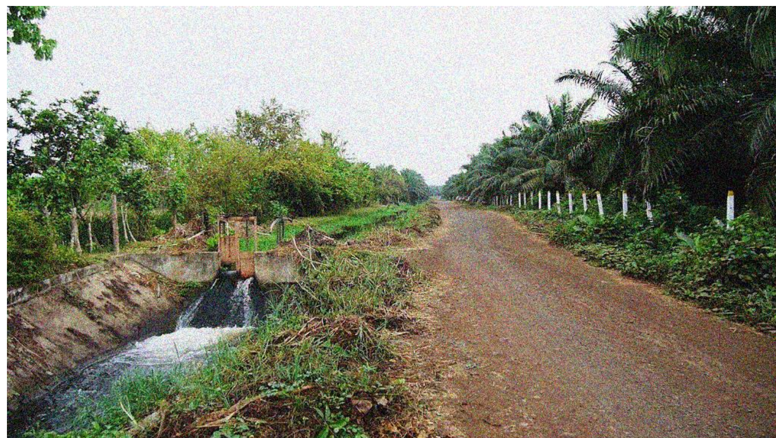
Compuertas Distrito de riego de Marialabaja, Bolívar
