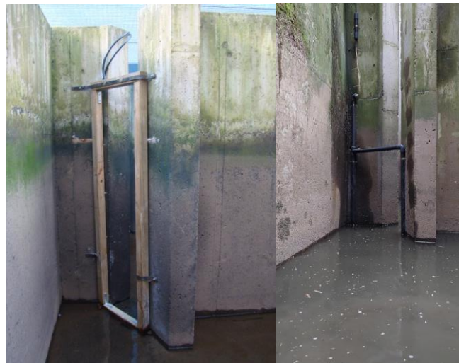
Figure 7 : Antenne de détection RFID au niveau d'une échancrure à l'amont de l'échelle à poissons du barrage des Grosses Battes sur la basse Ourthe à Liège (amont à gauche, aval à droite).
