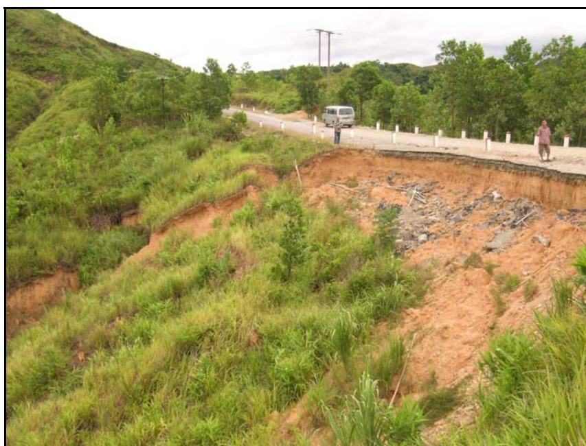
Figure 4.10. Glissement de terrain sur la route nationale N°49 à cause de l'érosion régressive
