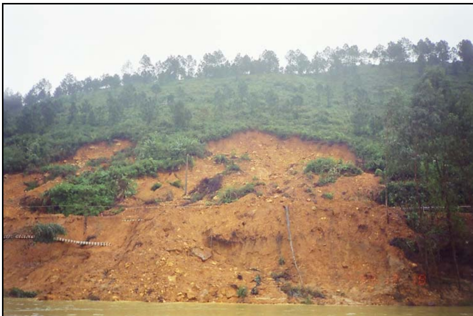
Figure 4.2. Glissement de terrain sur la route nationale N°49 au mont Chau Chu (Thuy Bang – Huong Thuy)
