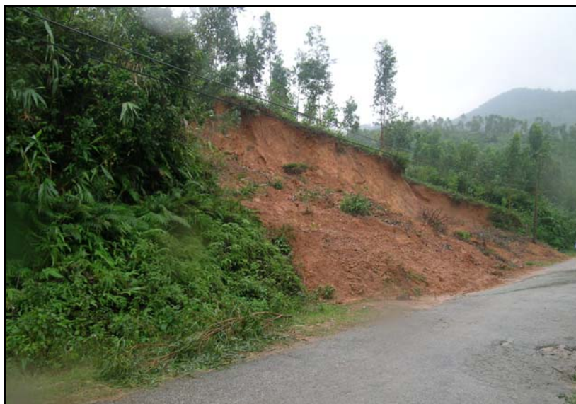
Figure 4.8. Glissement effectant la couche d'altération de granite le long de route reliant col de Phuoc Tuong et l'embouchure de Tu Hien
