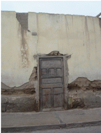
Fachada deteriorada y problemas de humedad en la cimentación son constantes.
