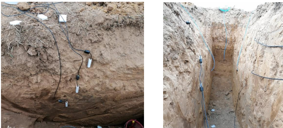
Figure 5. Installation des sondes et des plaques de prélèvements dans la tranchée de chaque parcelle
