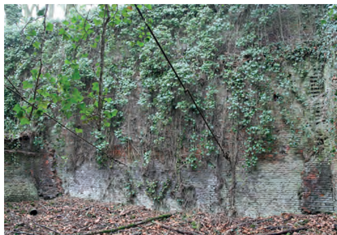
Fig. 23. Mariemont, orangerie, tirants en fer retenant la façade méridionale (© M. Demelenne, MRM)
