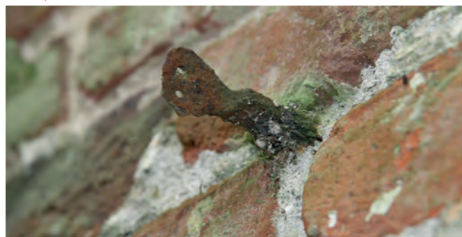
Fig. 22. Mariemont, orangerie, l'un des crampons du réseau d'attaches en fer des façades extérieures (© M. Demelenne, MRM)
