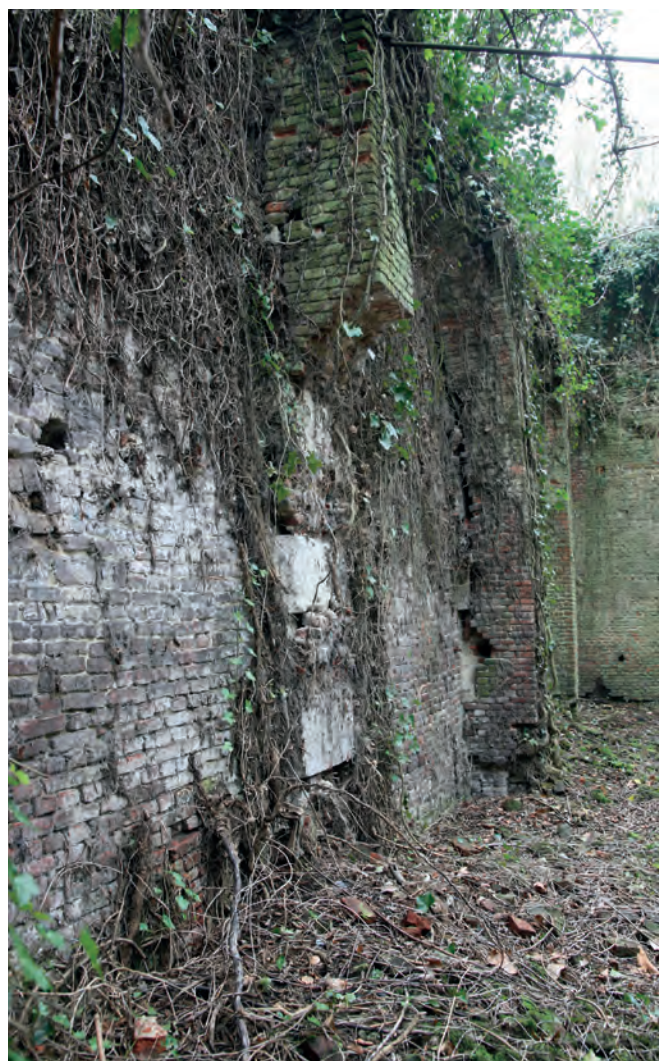
Fig. 24. Mariemont, orangerie, dévers de la façade méridionale vu depuis l'intérieur du bâtiment (© M. Demelenne, MRM)
