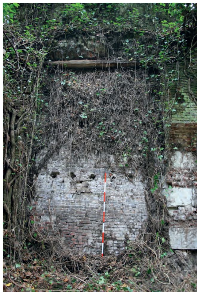
Fig. 18. Mariemont, orangerie, trous de boulins dans la 4 e travée (© M. Demelenne, MRM)
