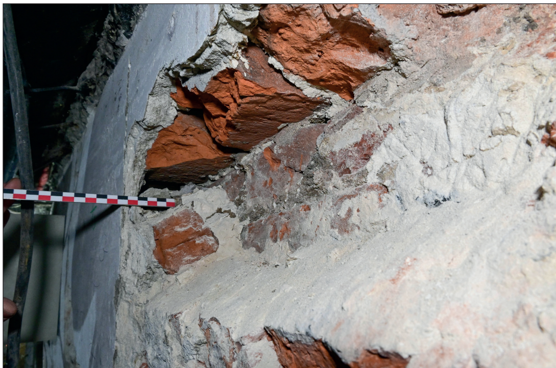
Fig. 12-13. Détail du retrait de maçonnerie sur deux assises du mur sud (secteur 1) (© urban.brussels-ULB)
