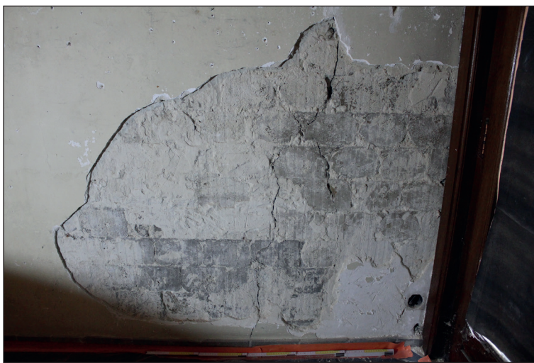
Fig. 38. Lacune dans les enduits muraux du rez-de-chaussée révélant des plaques cimentées.
