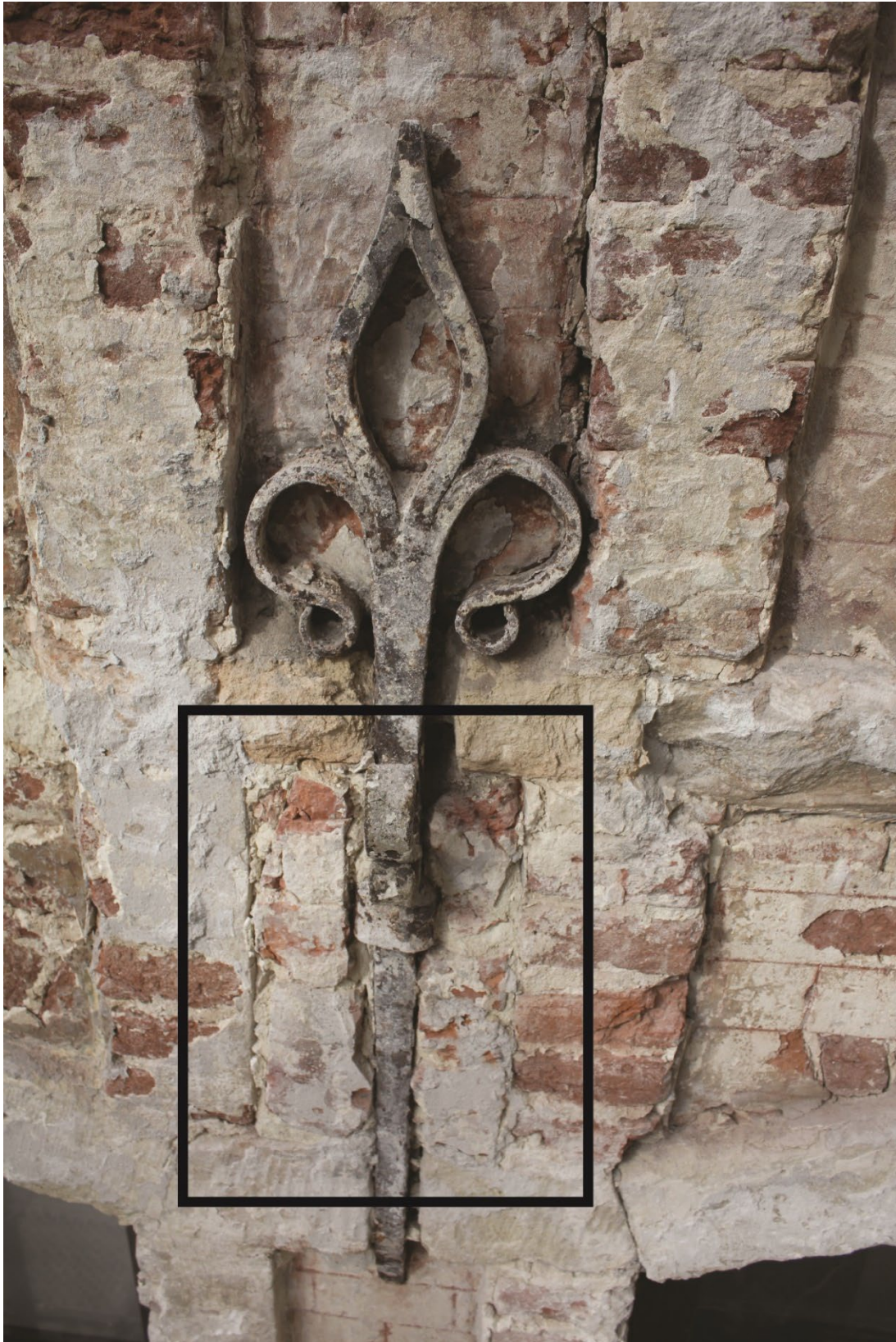
Fig. 26 : maçonnerie plaquée contre une des ancrs du deuxième étage. Photo : Antoine Baudry. © urban.brussels-ULiège.
