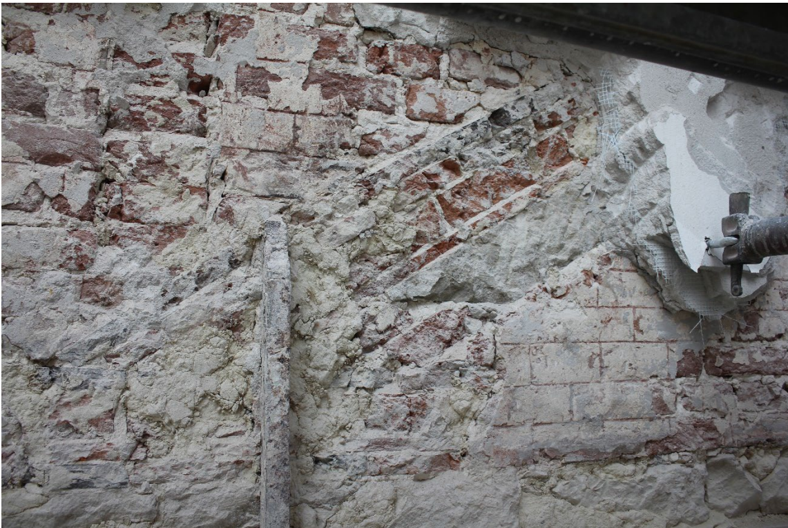
Fig. 18 : le fronton autrefois saillant couronnant la fenêtre centrale du premier étage. On distingue le cordon mouluré faisant office de corniche (en bas de l'image), la corniche rampante ainsi que le tympan sur lequel est apposé un enduit rouge représentant un faux appareil de briques. Photo : Antoine Baudry. © urban.brussels-ULiège.
