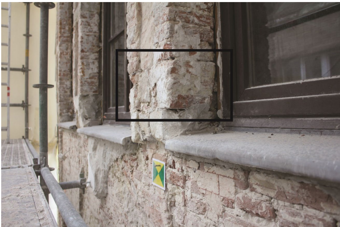
Fig. 8 : localisation du niveau des appuis primitifs des fenêtres du deuxième étage. Photo : Antoine Baudry. © urban.brussels-ULiège.
