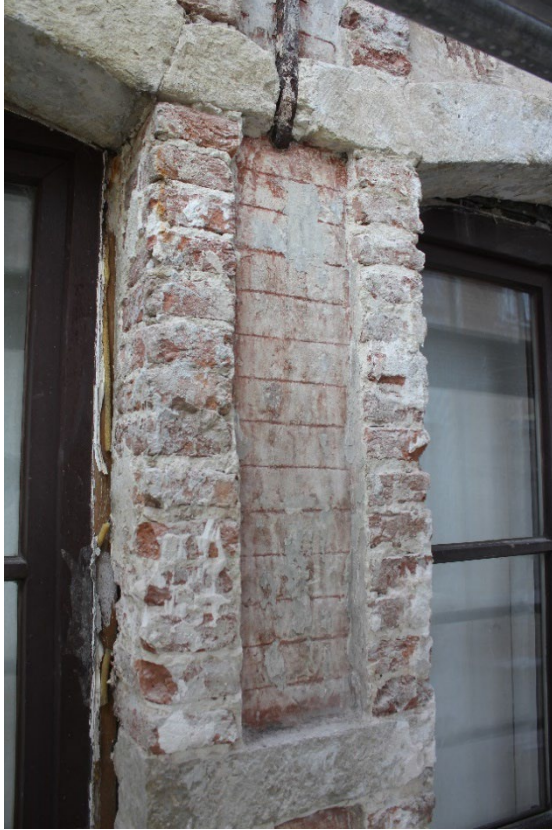
Fig. 13 : exemple du compartimentage géométrique de la façade obtenu par la saillie d'élément tels qu'ici, piédroits, arcs et cordons. Photo : Antoine Baudry. © urban.brussels-ULiège.
