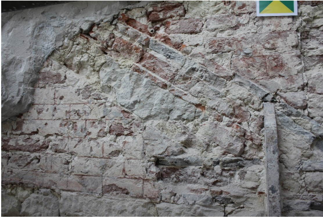
Fig. 19 : le fronton autrefois saillant couronnant la fenêtre centrale du premier étage. On distingue le cordon mouluré faisant office de corniche (en bas de l'image), la corniche rampante ainsi que le tympan sur lequel est apposé un enduit rouge représentant un faux appareil de briques. Photo : Antoine Baudry. © urban.brussels-ULiège.
