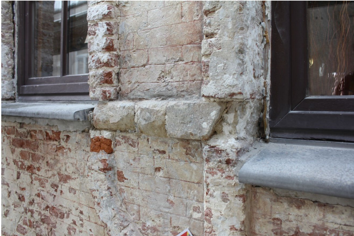
Fig. 9 : à gauche, l'appui de la fenêtre centrale du pignon, dans son alignement d'origine. À droite, l'appui de la fenêtre latérale, abaissé d'une dizaine de centimètres. Photo : Antoine Baudry. © urban.brussels-ULiège.
