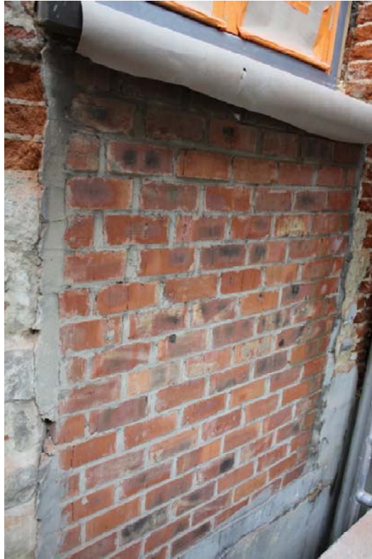
Fig. 9 : comblement US6 de la baie n°6 en briques industrielles. Photographie : A. Baudry. © urban.brussels-ULiège.
