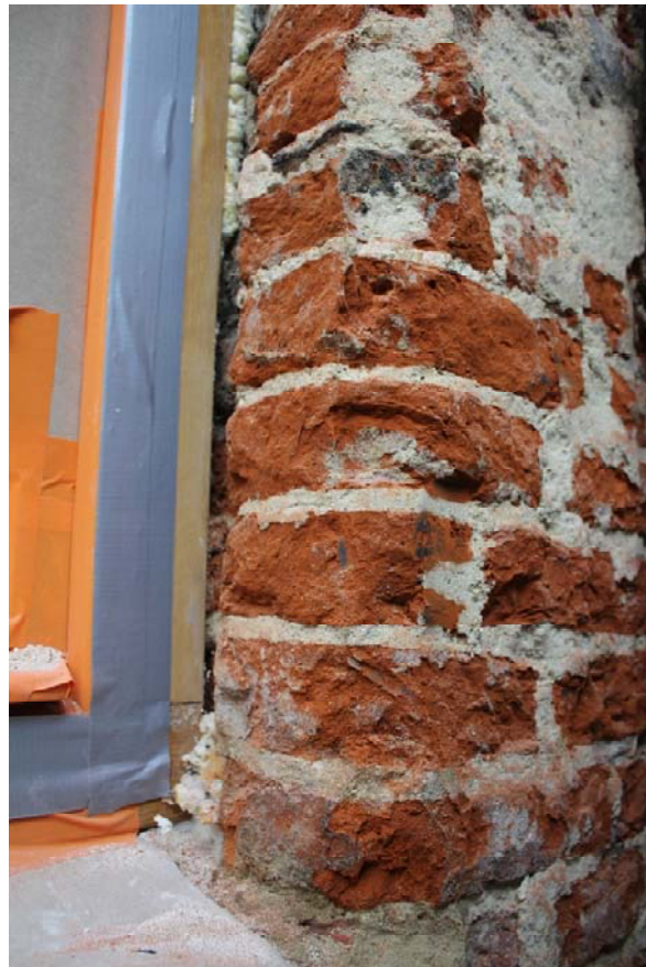
Fig. 8 : piédroit en briques chanfreinées de la baie (n°6 ou n°12). Percement ultérieur (US5 ?) de la façade US1 ? Photographie : A. Baudry. © urban.brussels-ULiège.
