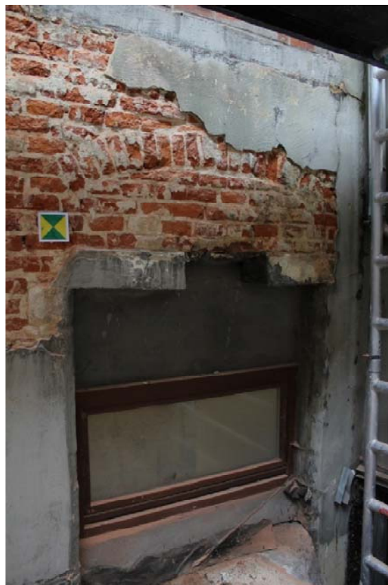
Fig. 10 : l'ancienne porte (baie n°3), son arc de décharge et son linteau (anciennement) monolithe en pierre bleue. Photographie : A. Baudry. © urban.brussels-ULiège.
