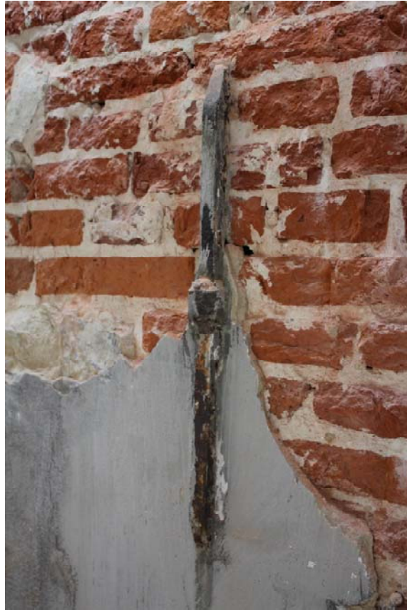
Fig. 11 : ancre US12 du rez-de-chaussée. Photographie : A. Baudry. © urban.brussels-ULiège.
