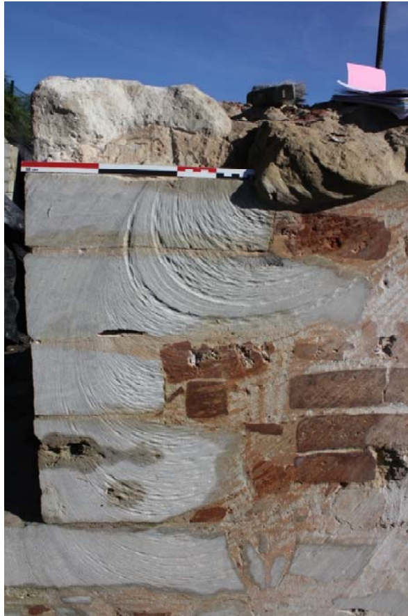
Fig. 3 : coupe des moellons à têtes dressées aux queues démaigries, fourrure garnie de briques fragmentaires (bloc n°6). Photographie : Antoine Baudry (BR346_20220929_009_ABaudry). © urban.brussels-ULiège.
