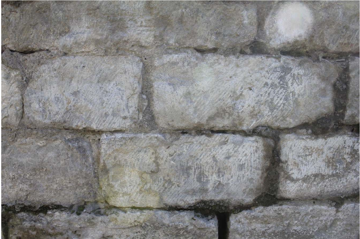
Fig. 21 : parement des moellons à têtes dressées mêlant taille fine perpendiculaire serrée (en bas) et taille oblique moins soignée (bloc n°9). Photographie : Antoine Baudry (BR346_20220929_019_ABaudry). © urban.brussels-ULiège.
