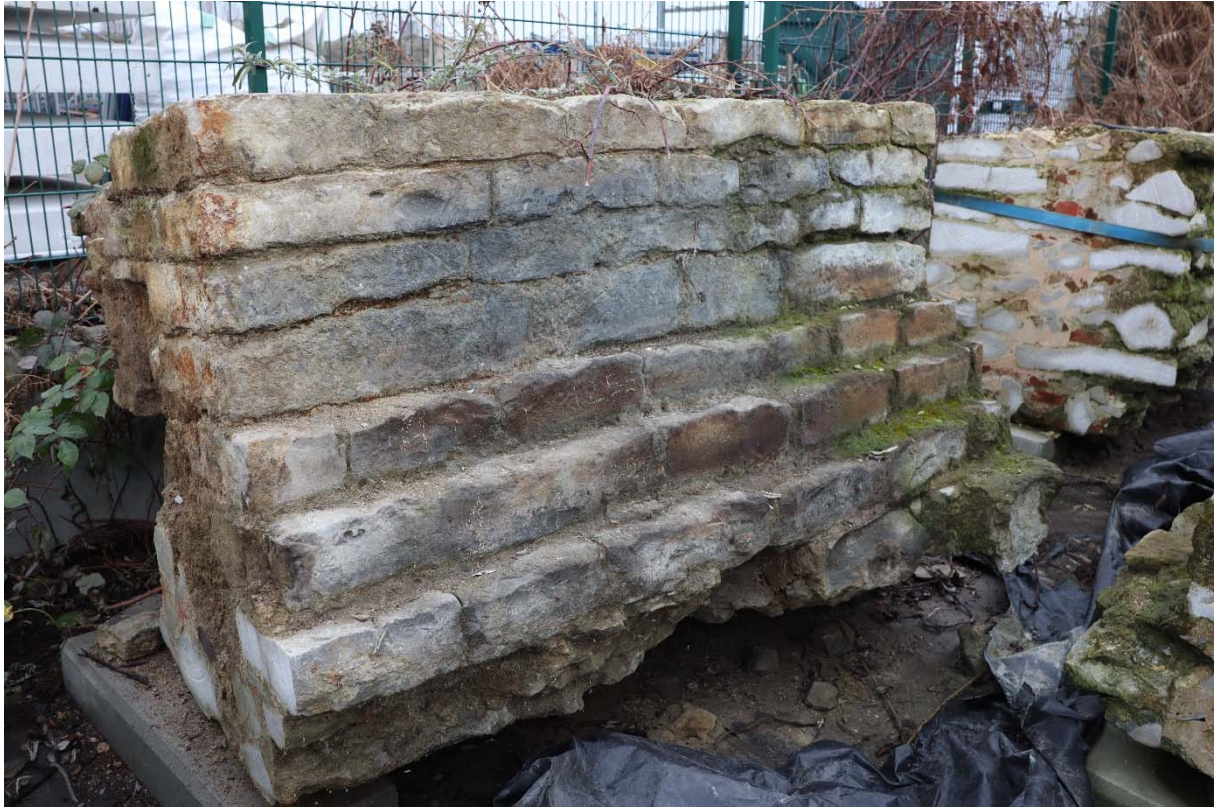
Fig. 13 : érosion importante des pierres (bloc n°3). Photographie : Valérie Ghesquière. © urban.brussels.
