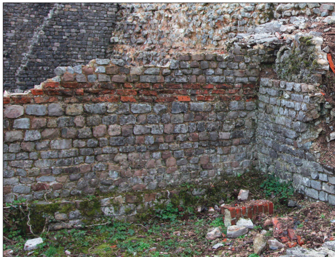
Fig. 3 – Le mur RB27 (fait architectural 6 ; technique H), de la boutique extérieure à l'aire sacrée B027 (cliché : C. Louvion).
