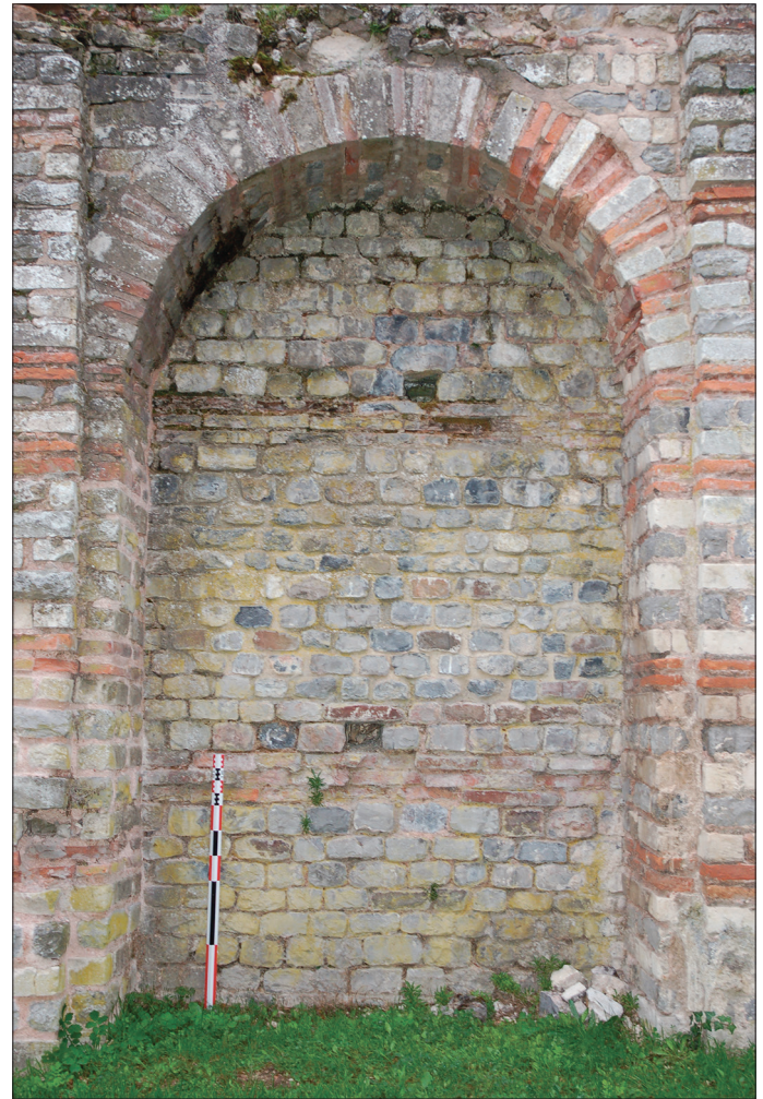
Fig. 12 – Le mur sud MEO04 (fait architectural 25 ; technique I), les demi-piliers PS15-16 (fait architectural 26 ; technique B) et l'arc F01 (fait architectural 27 ; technique AA) sous l'édifice occidental (cliché : C. Louvion).
