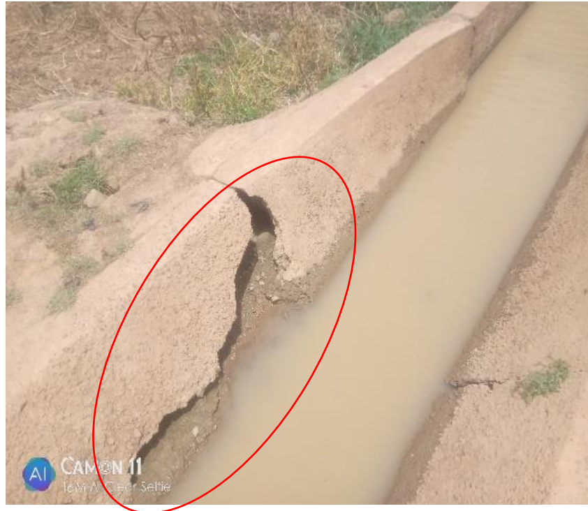
Forte dégradation du béton favorisant des fuites d'eau
