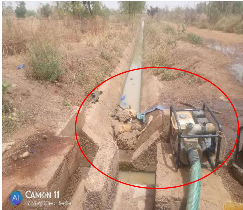
Présence de pierres et pompage illégal ou anormal dans le canal
