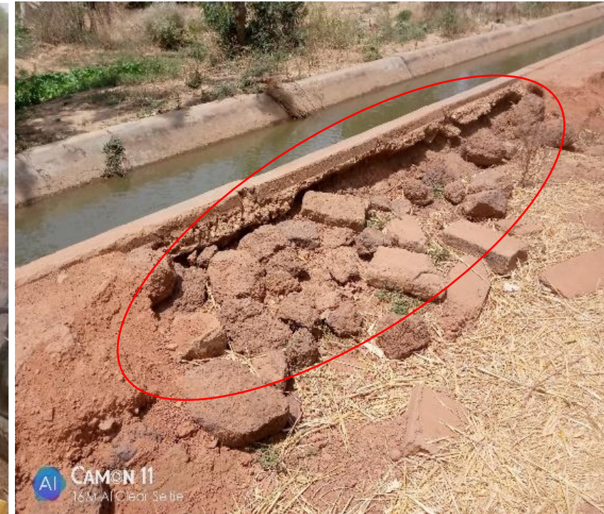
Déchaussement du plot/absence de remblai du cavalier
