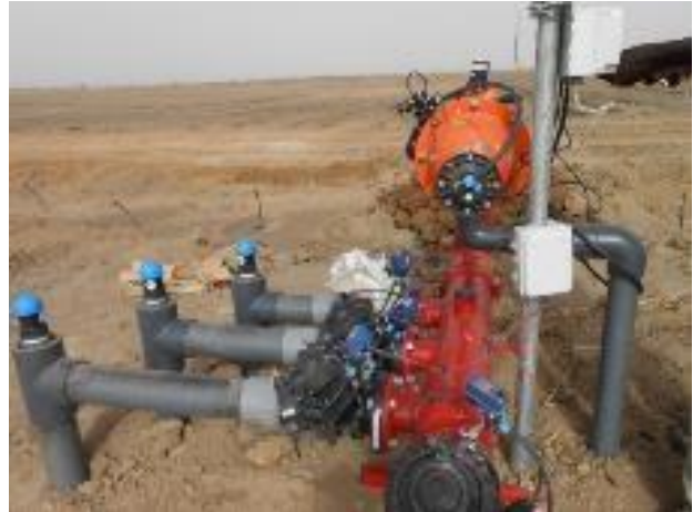
Photo 5 : Dispositif de filtration à la parcelle (Sall, 2017)
