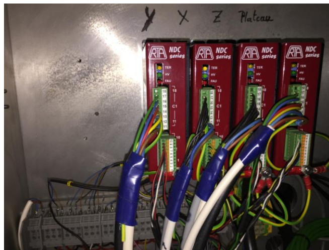
Figure 9 : Photos des modules de contrôle des moteurs.
