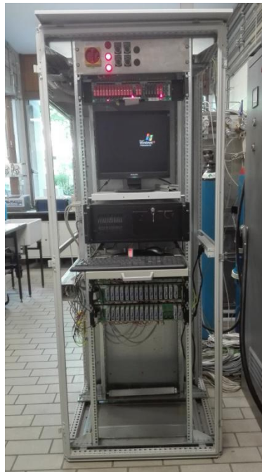
Figure 3.9 : Armoire de commande et d'alimentation électrique.
