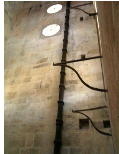
Une canalisation où circulait les eaux de la Seine
