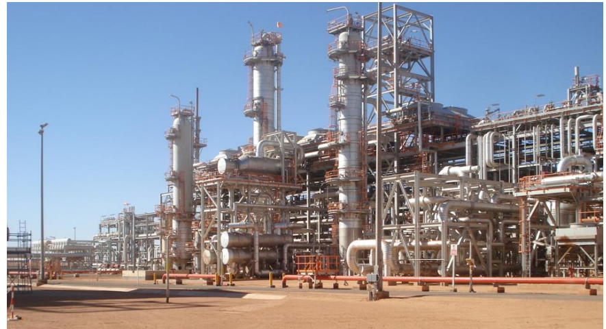
Algérie, 2017. Adoucissement du gaz naturel, qui contient parfois près de 80% de CO 2 ! Echelle: 1400-2800 tonnes par jour CO 2
