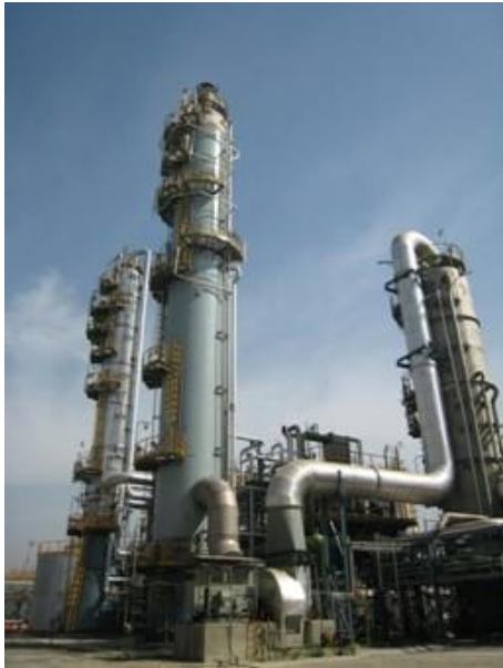
Inde, 2006, production d'ammoniac Echelle: 2x450 tonnes par jour CO 2
