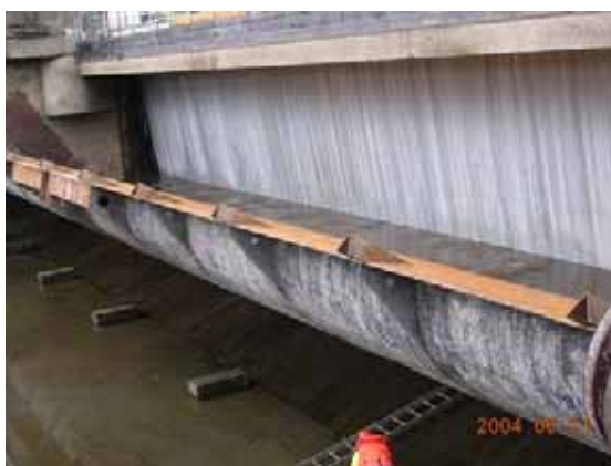
Figure 8 : Photo du batardeau amont à poutre flottante et aiguilles
