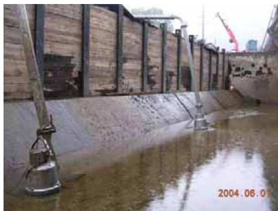
Figure 25 : Batardeau aval à poutrelle
