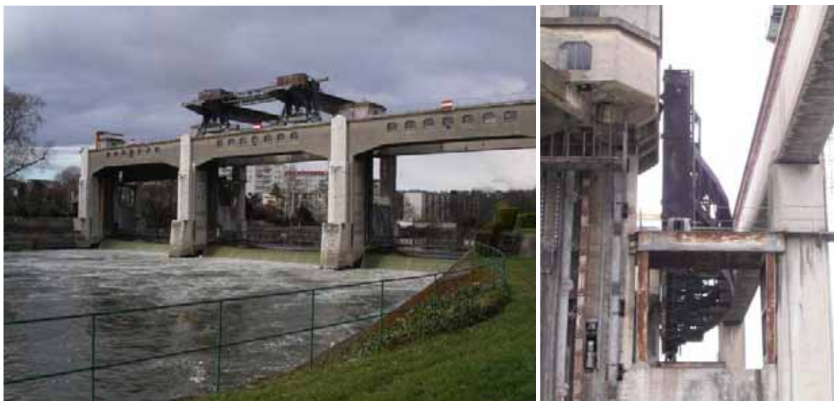
Figure 19 : Batardeau pour vanne levante (barrage de Chatou)
