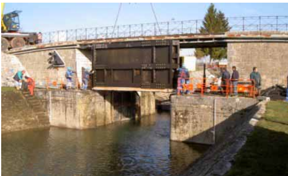
Figure 14 : Batardeau de type panneau (Saône) 1
