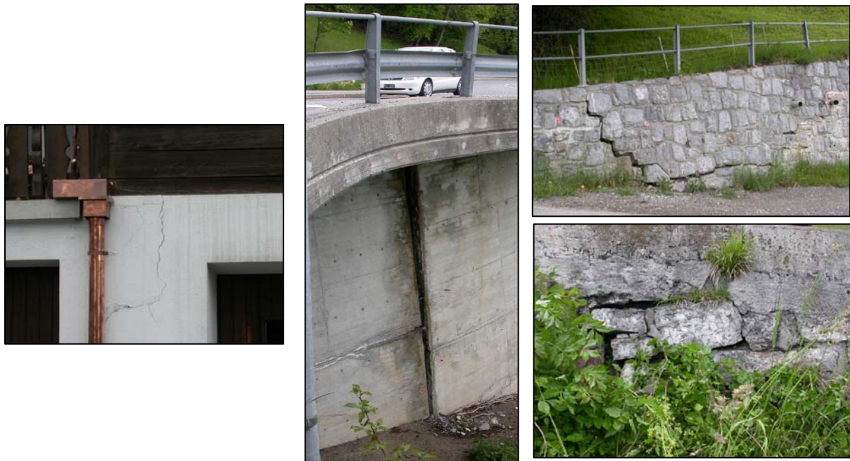
Figure 2-1 : Dégâts sur les ouvrages (Versant de Triesenberg)
