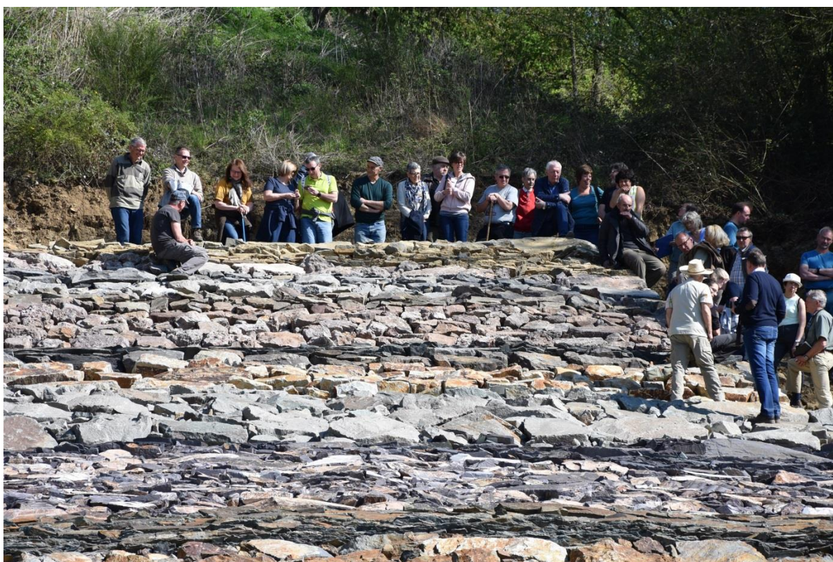
Fig. 20 - Une visite lors de la pose du grès famennien (couleur ocre au sommet de la construction).
