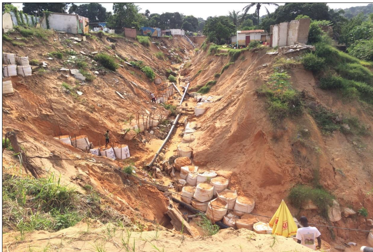
Photo 2 : Les conséquences des érosions à KINDELE. Photographie réalisée par l'auteur en juin 2018 sur la route Kimwenza, à KINDELE.
