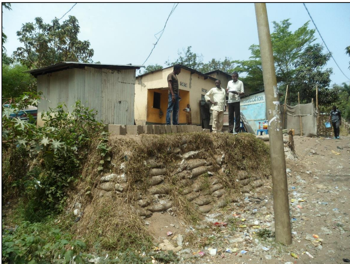
Photo 10.1.1b : Le problème de durabilité posé régulièrement par le soutènement de talus en sacs du polypropylène remplis de terre et planté de paspalum : détérioration des sacs. Photographie réalisée par l'auteur en 2017.
