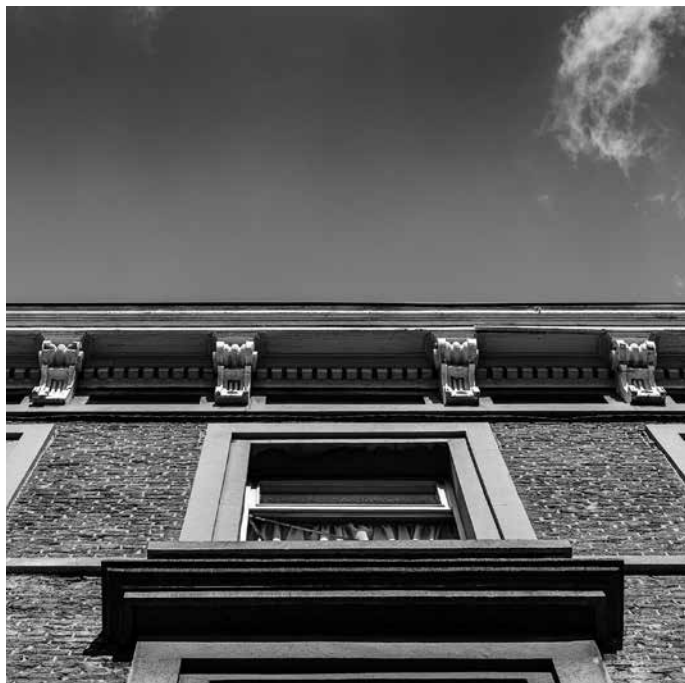
Détail du bâtiment ayant accueilli l'Union des Femmes de Wallonie, rue Dartois à Liège
