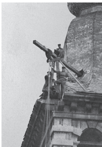
Fig. 23.- Système de levage installé dans l'angle nord-ouest de la tour de l'église Saint-Jean-Baptiste à Namur, probablement vers 1891.
