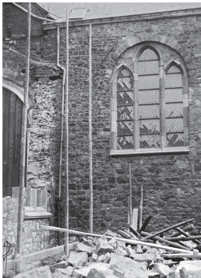
Fig. 31.- Vestiges de l'échafaudage ayant servi à démolir le mur-gouttereau du collatéral sud de la nef de l'église Saint-Christophe à Liège, vers 1875-1876. © Liège, Centre d'Archives et de Documentation de la C.R.M.S.F., fonds de la C.R.M.S.F., dossier « Liège 1.18 ».
