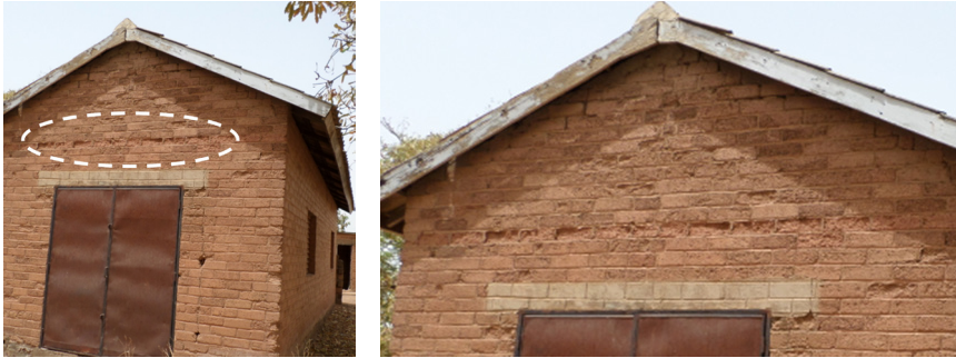
Fig. 6. — Érosion des murs en BTC non stabilisées, exposées à la pluie, Ouagadougou, Burkina Faso (d'après Nshimiyimana et al. , 2020c).
