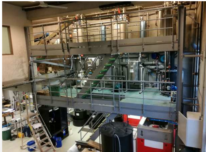
Installation pilote d'hydrométallurgie @ULiege
