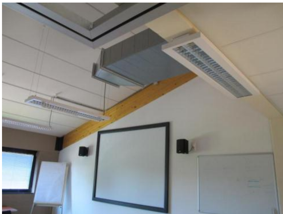
Figure 8 : Eclairage général des bureaux
