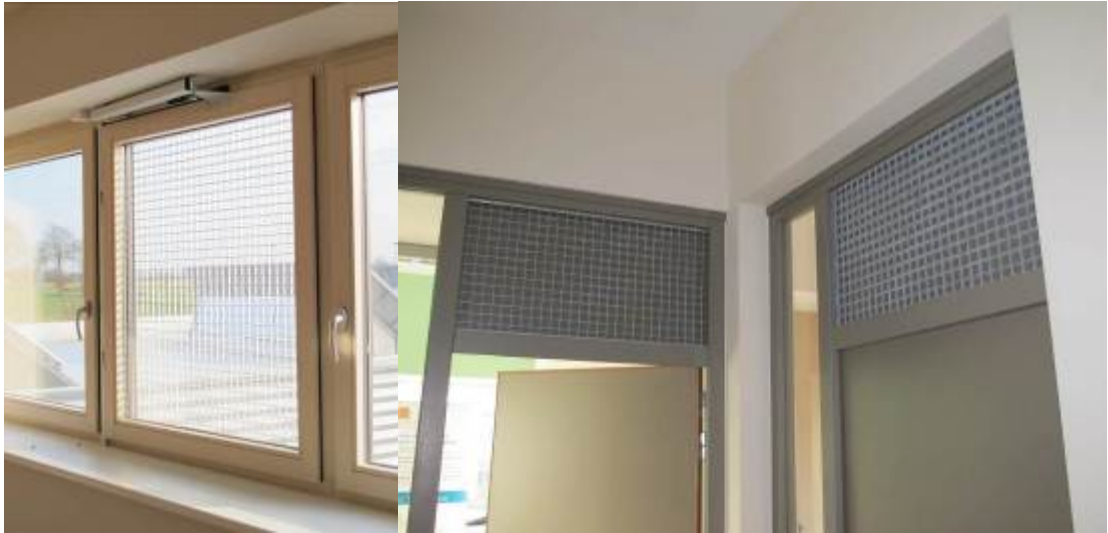
Figure 9 : Dispositif de ventilation transversale via les fenêtres extérieures et l'imposte des portes intérieures
