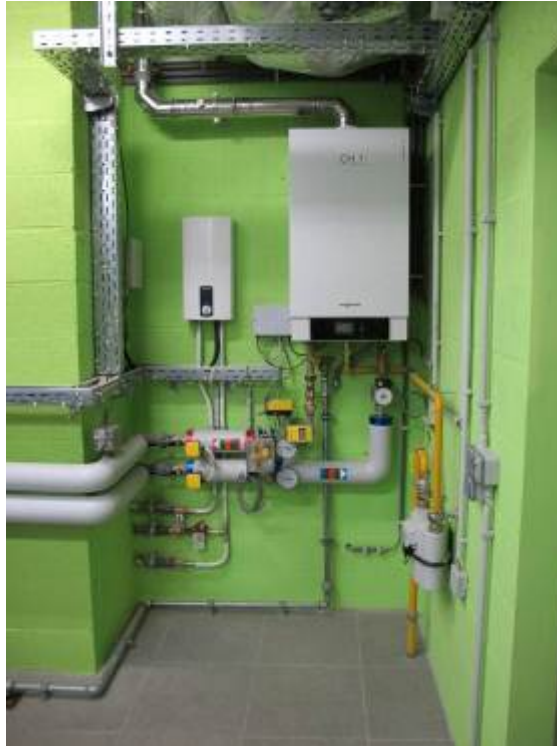
Figure 10 : Production de chaleur par une chaudière à condensation (à droite) pour le chauffage, et un chauffe-eau électrique (à gauche) pour l'eau chaude sanitaire
