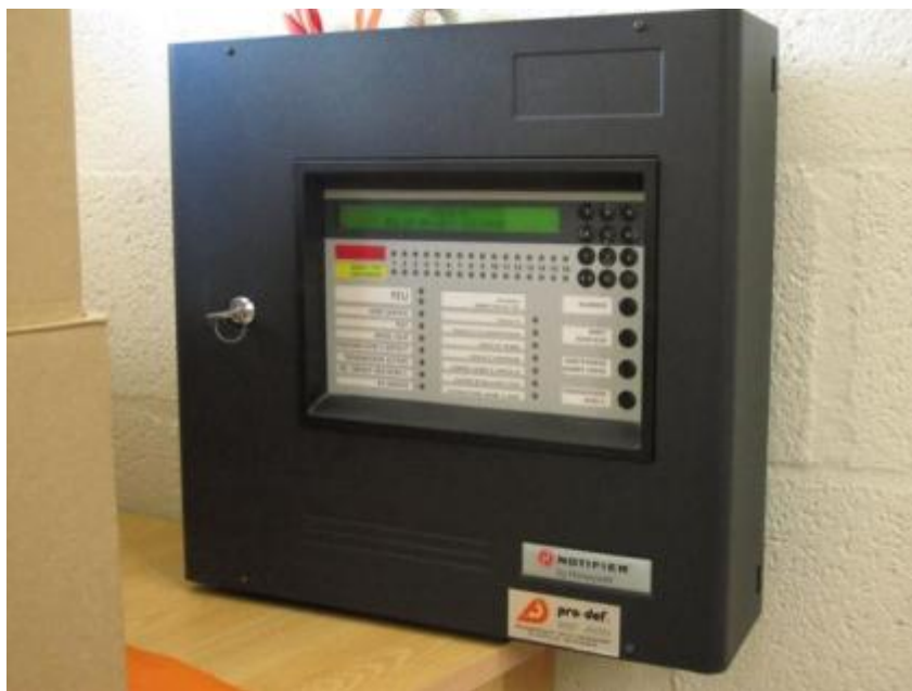
Figure 11 : Centrale d'alarme incendie
