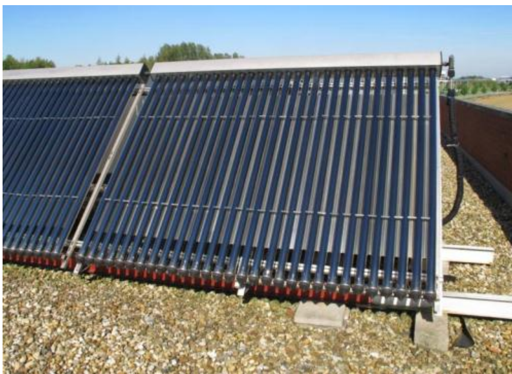
Figure 12 : Capteurs solaires thermiques pour le préchauffage de l'eau chaude sanitaire utilisée dans la cafétéria et pour la salle de fitness
