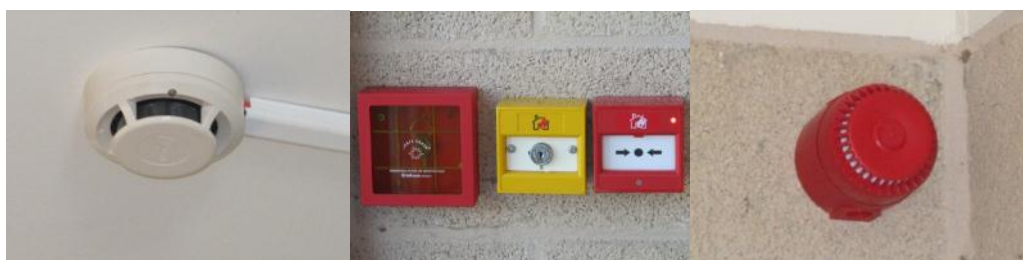
Figure 10 : Détecteurs, alerte et alarme incendie (Eridan)
