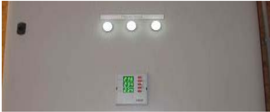
Figure 23 : Electricité produite par les panneaux photovoltaïques
