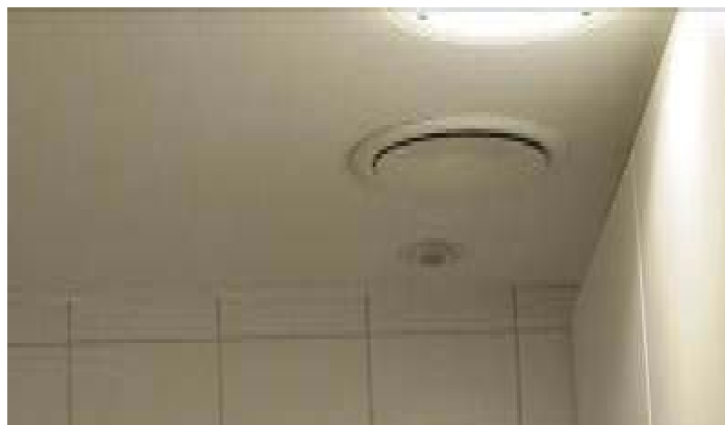
Figure 17 : Détection de présence dans les locaux sanitaires
