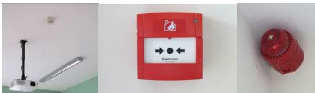
Figure 20 : Détecteurs, alerte et alarme incendie
