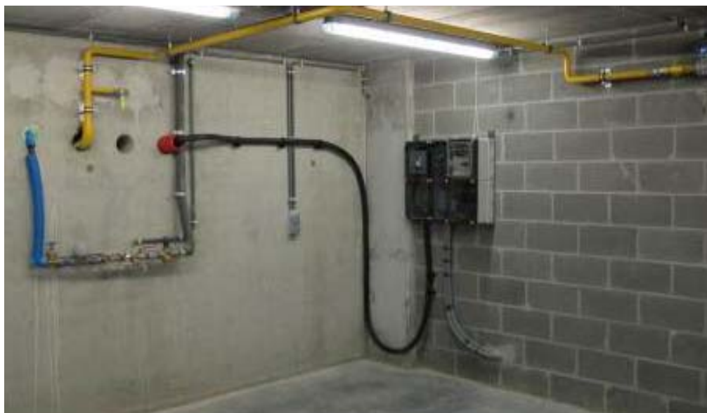
Figure 25 : Comptage individuel de la consommation électrique
