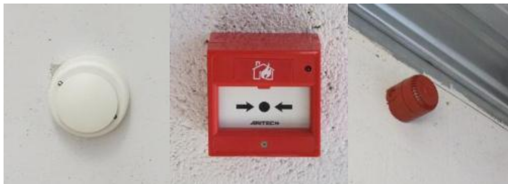
Figure 10 : Détecteurs, alerte et alarme incendie
