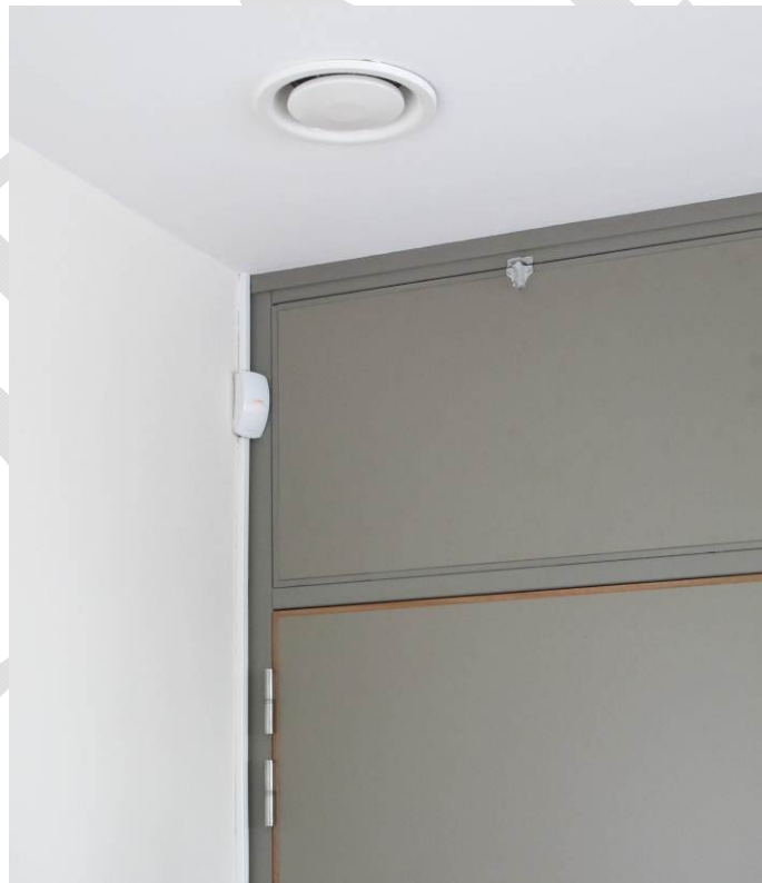
Figure 6 : Emission de la chaleur par les bouches de ventilation
