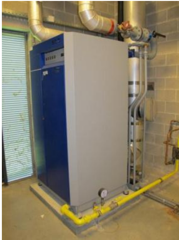
Figure 4 : Chaudière au gaz, à basse température
