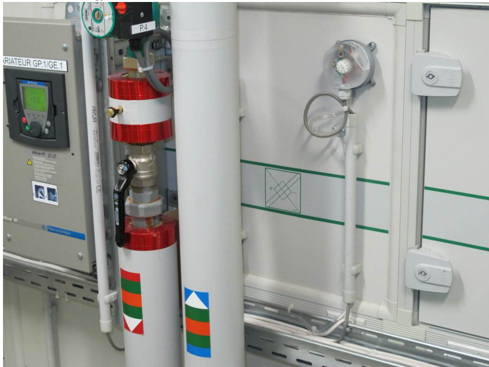
Figure 7 : Récupérateur de chaleur
