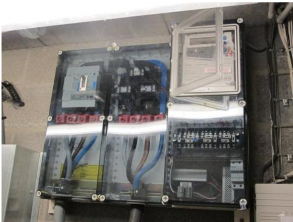
Figure 14 : Comptage individuel de la consommation électrique
