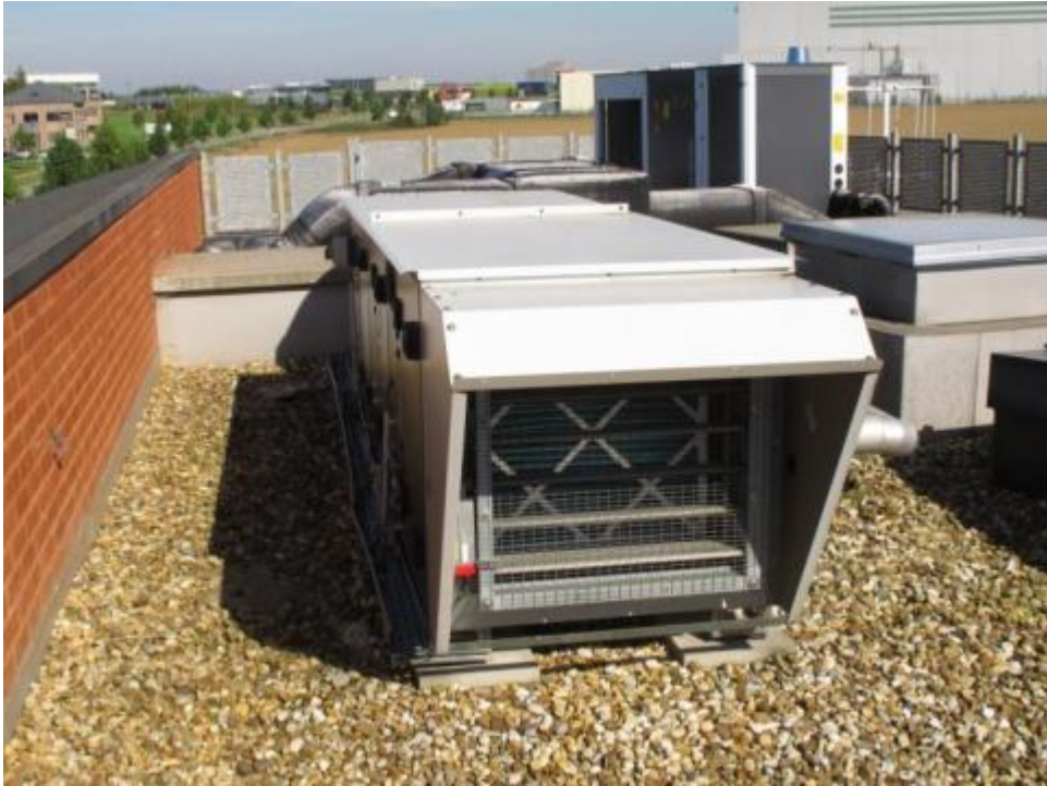
Figure 3 : Groupe de ventilation en toiture
