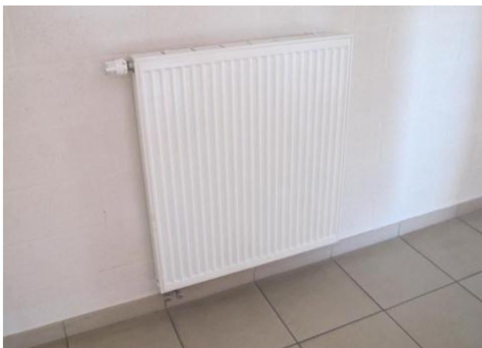
Figure 6 : Emission de la chaleur par des radiateurs
