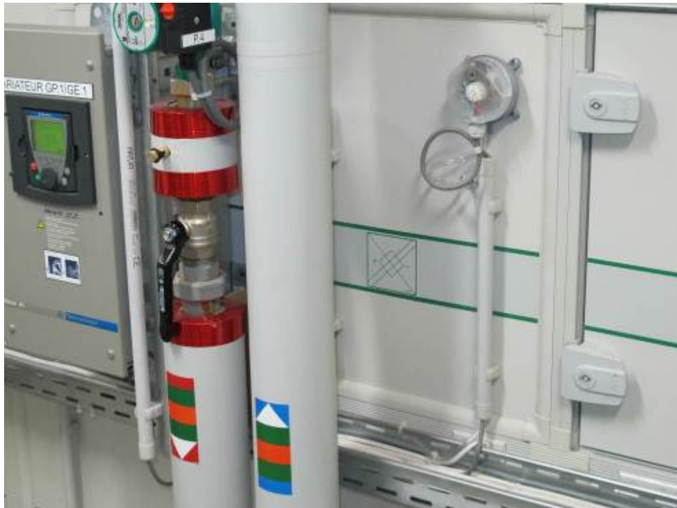
Figure 13 : Récupérateur de chaleur
