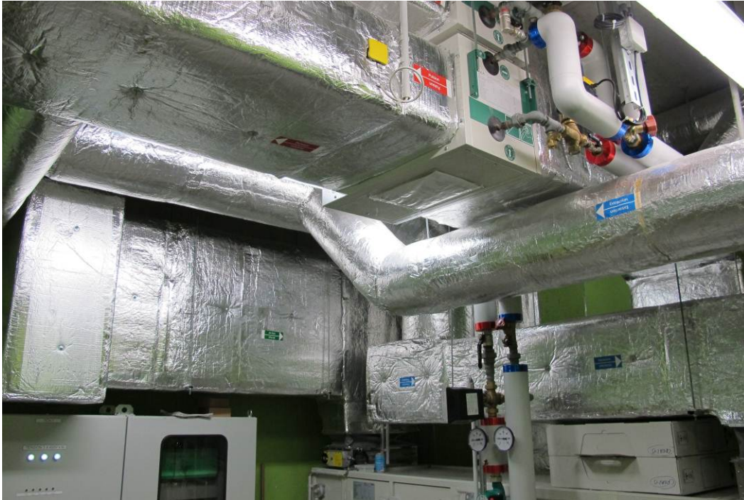
Figure 5 : Distribution de la chaleur dans les locaux (en rouge : air pulsé, chaud ; en bleu : air extrait)
