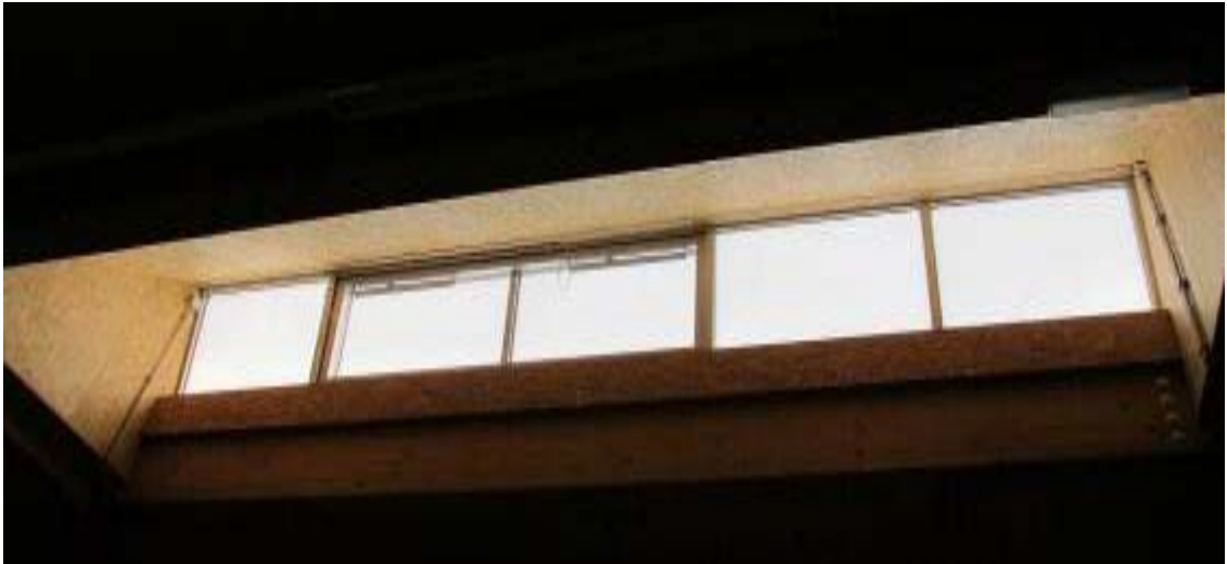
Figure 21 : Exutoires de fumées dans les ateliers
