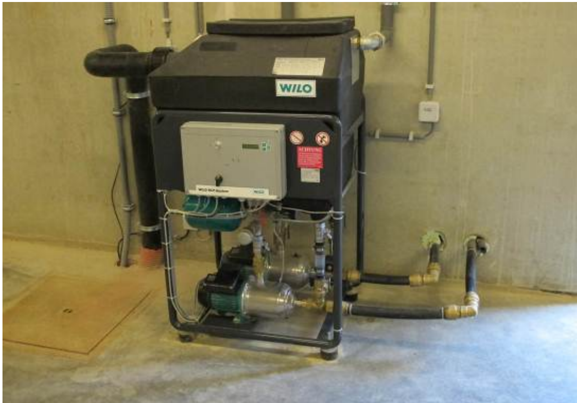
Figure 27 : Groupe hydrophore pour récupérer les eaux de pluie
