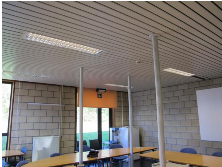
Figure 8 : Eclairage général des bureaux et salles de réunion (Pégase)
