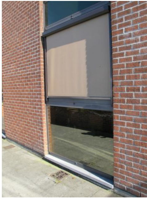
Figure 3 : Stores extérieurs (Pégase)
