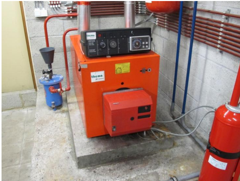
Figure 4 : Chaudière au mazout, à basse température (Pégase)
