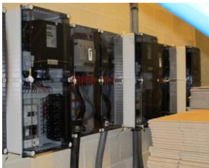
Figure 12 : Comptage individuel de la consommation électrique
