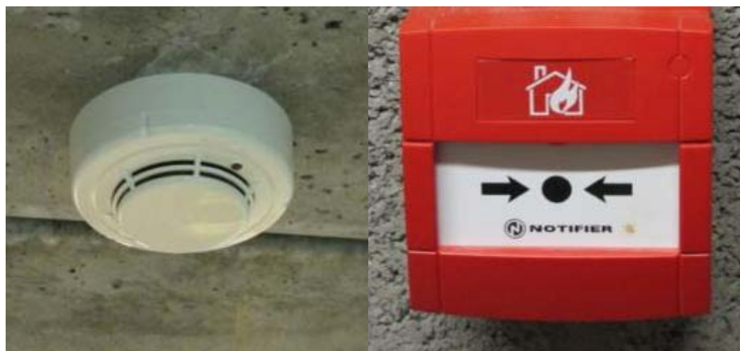
Figure 10 : Détecteurs et alerte incendie
