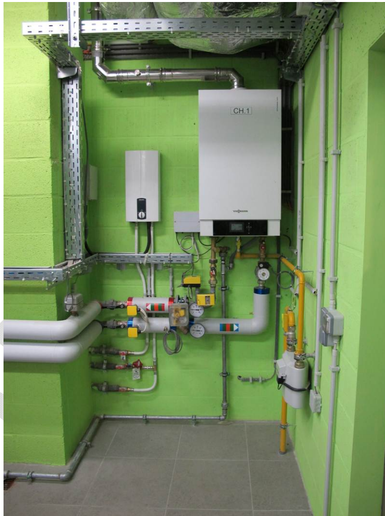
Figure 4 : Production de chaleur par une chaudière à condensation (à droite) pour le chauffage, et un chauffe-eau électrique (à gauche) pour l'eau chaude sanitaire
