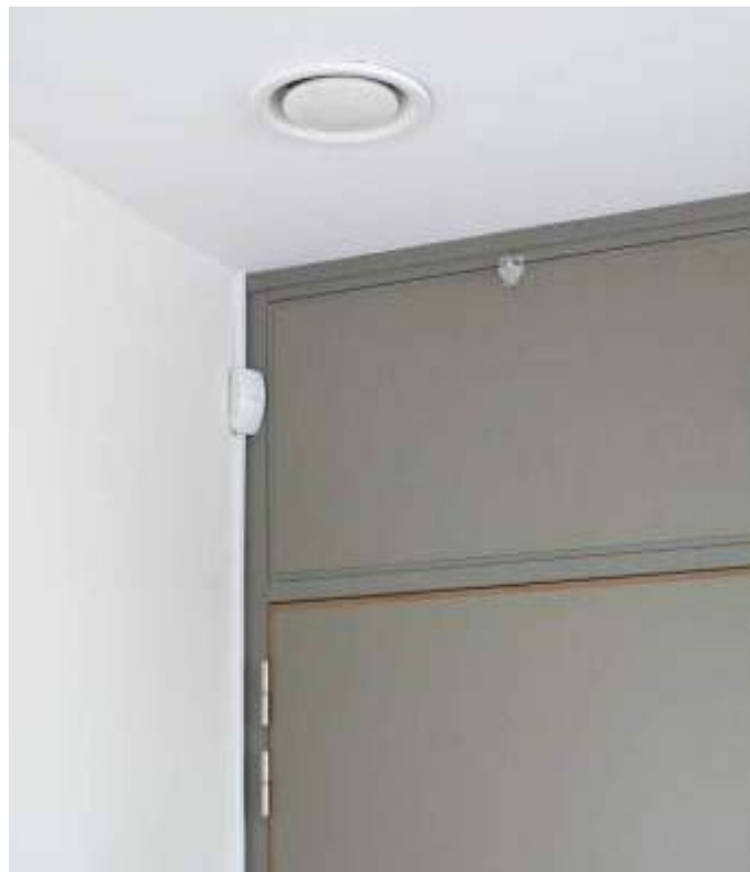
Figure 12 : Emission de la chaleur par les bouches de ventilation
