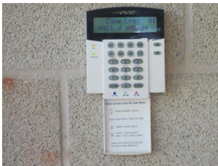
Figure 10 : Contrôle d'accès (Eridan)
