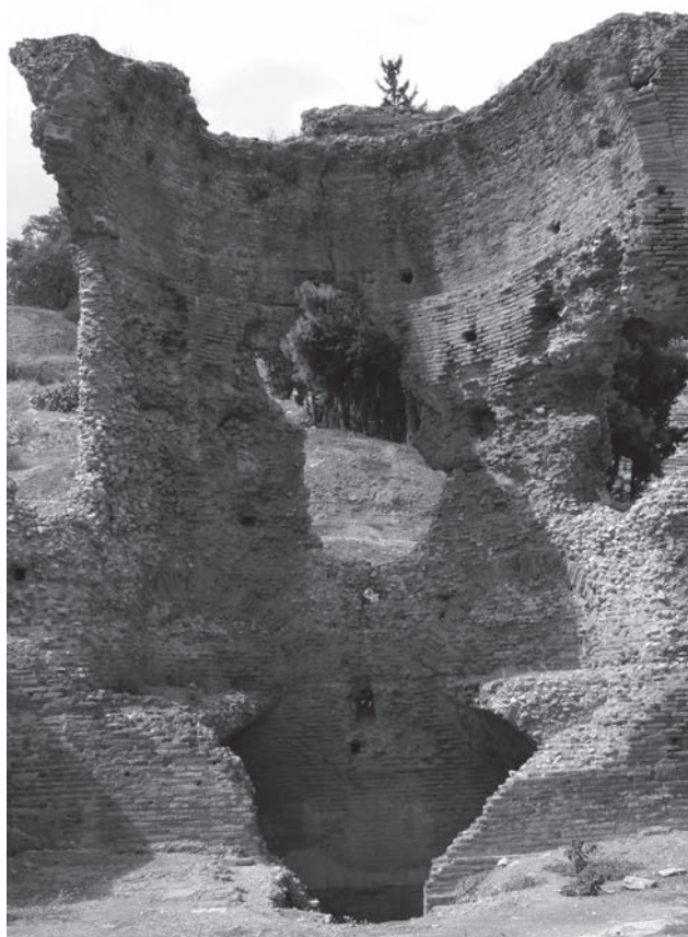
Fig. 29. Abside de la "cella" de l'état I des Thermes A, Argos (cl. EfA, R. Veymiers 2006).
