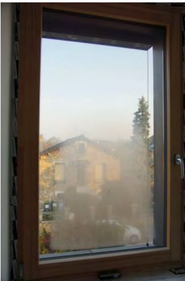
CONDENSATION SUR LA FACE EXTERNE DU VITRAGE
