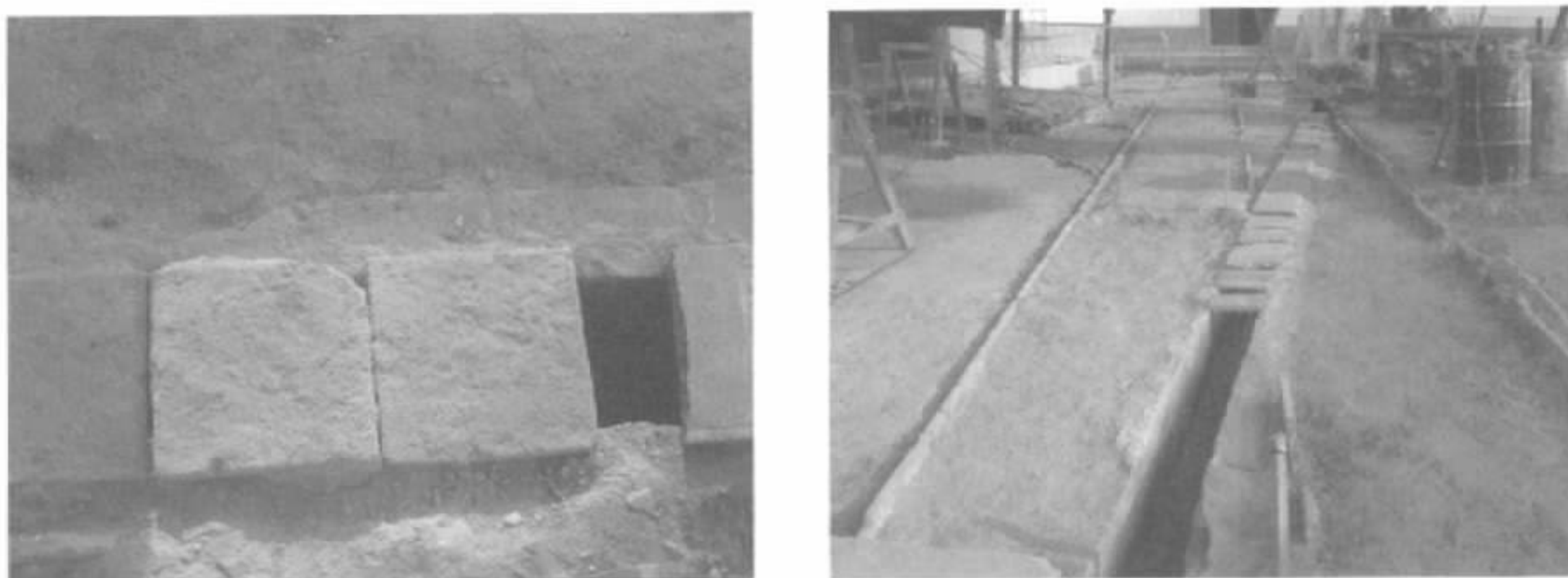
Figura 6 – Calha: a) Detalhe dos pisos de lajotas originais que recobrem a superfície da calha. b) Vista da calha coberta por alguns pisos de lajotas. Fotos Guadalupe Campos, 2007.
