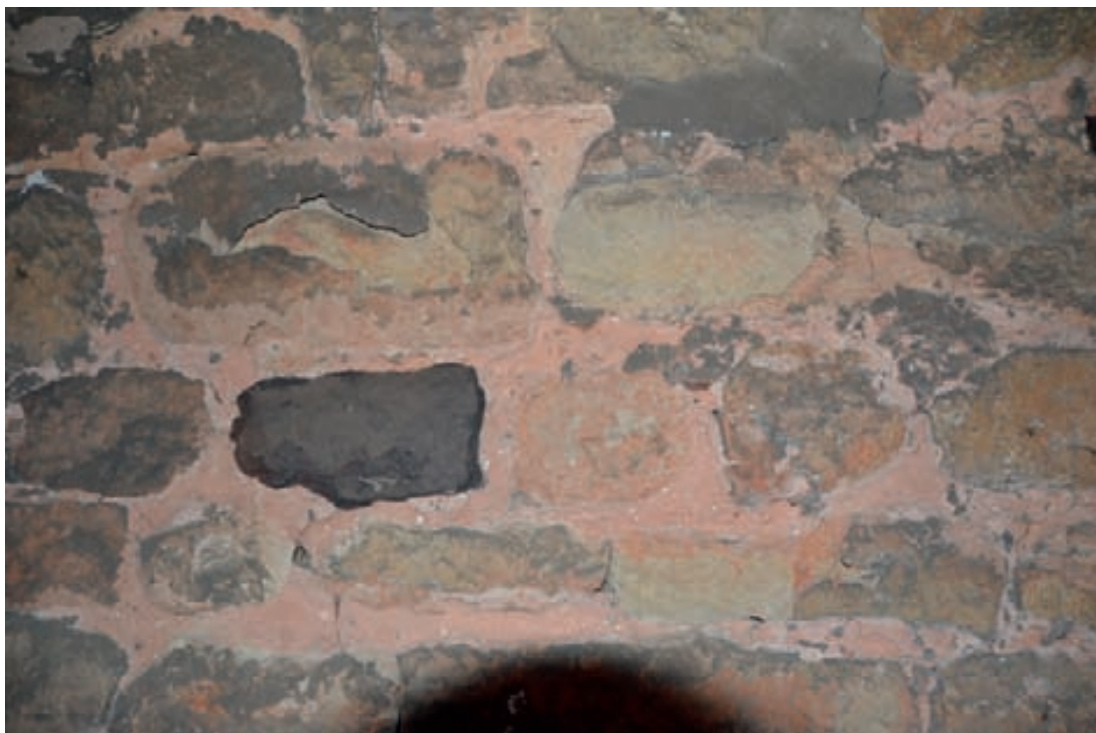
Fig. 12. Vue des maçonneries intérieures de la tour, deuxième étage, présentant des pierres calcinées et du mortier roussi (cliché Paulo Charruadas, 2013)
