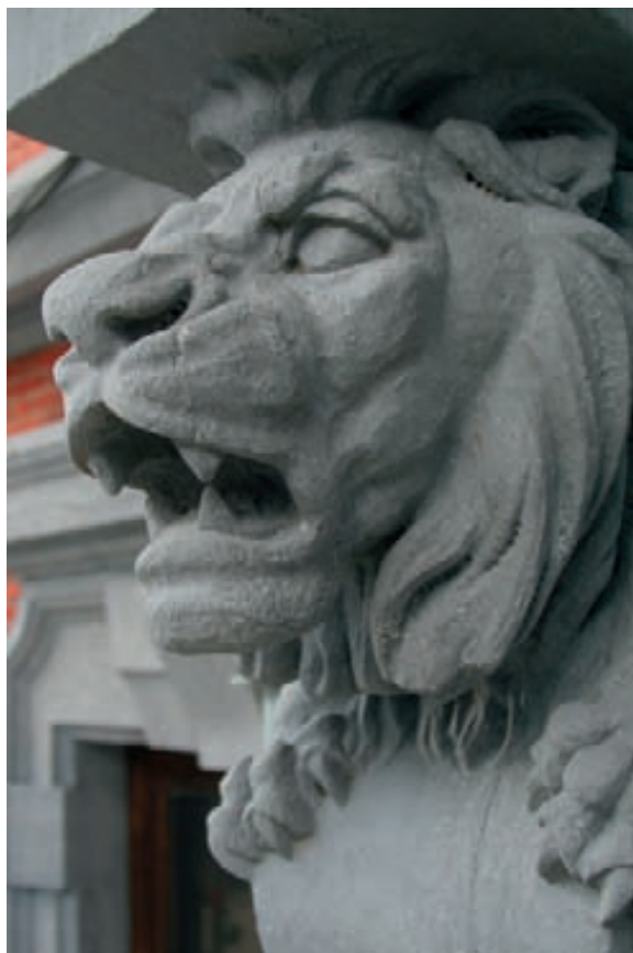
Une des deux consoles en forme de lion supportant la logette en façade à rue. Petit granit taillé. (© Vincent Heymans – Cellule Patrimoine Historique).
