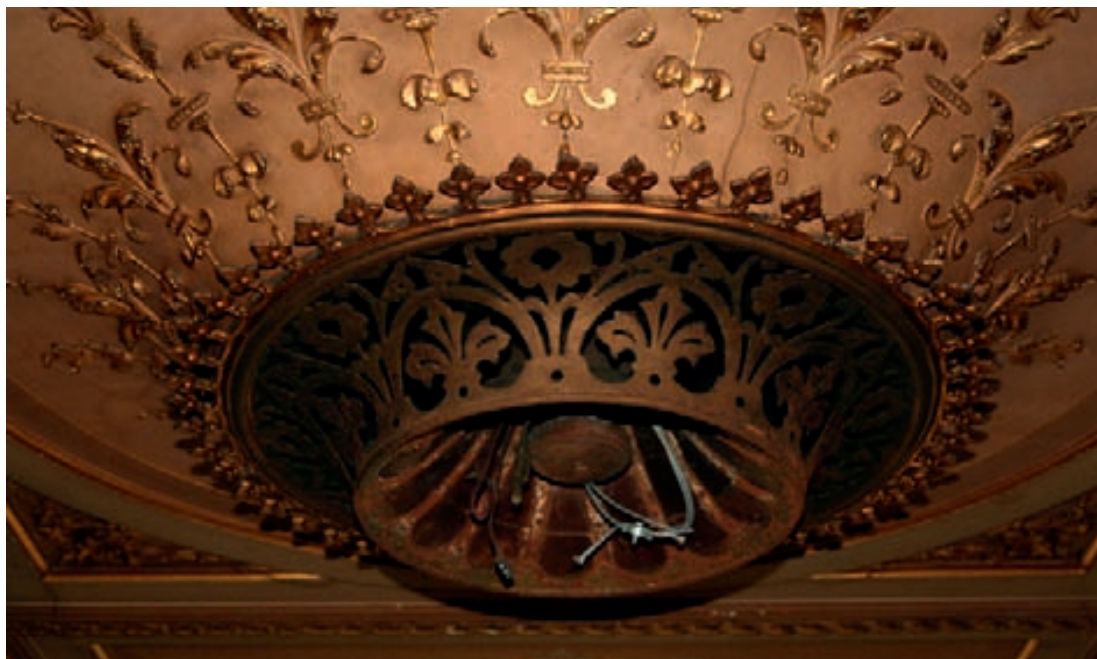
Le Ventilating Sunburner de la salle à manger. Les conduits sont conservés mais la rampe de brûleurs a disparu, probablement supprimée lors du passage à l'électricité (© Vincent Heymans – Cellule Patrimoine historique).
